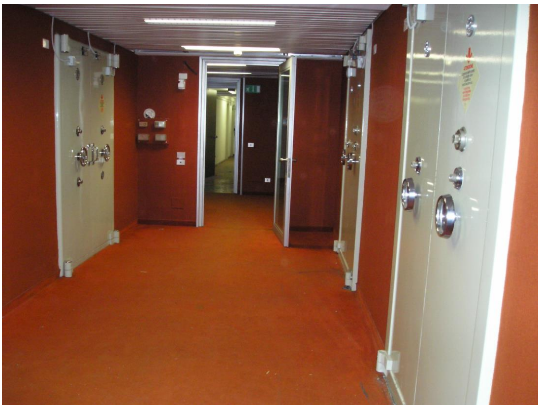
22. Il caveau della banca con le casseforti, nel sotterraneo
