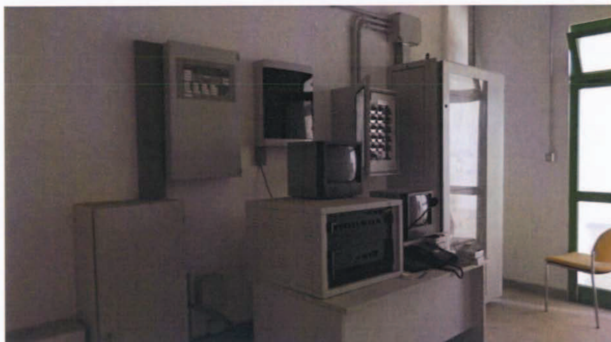
Sala di controllo accessi
