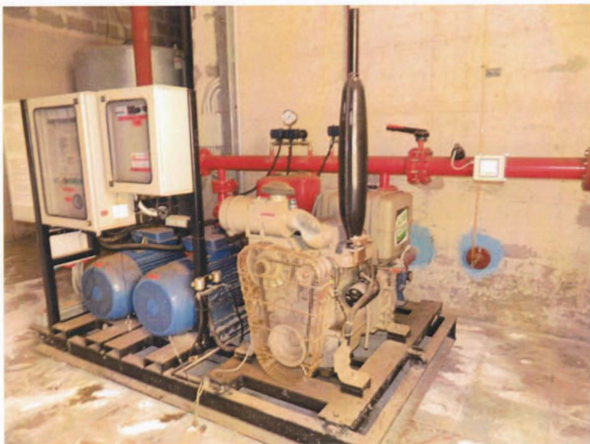
Gruppo elettropompe e motopompe antincendio
