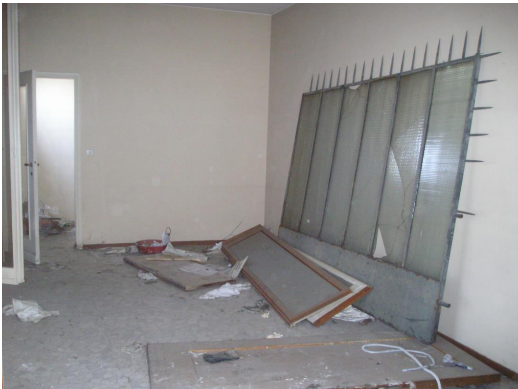
12. Materiale ammassato in un appartamento dell'ultimo piano
