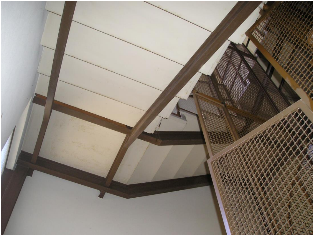
13. La struttura metallica di protezione antisismica in uno dei vani scala
