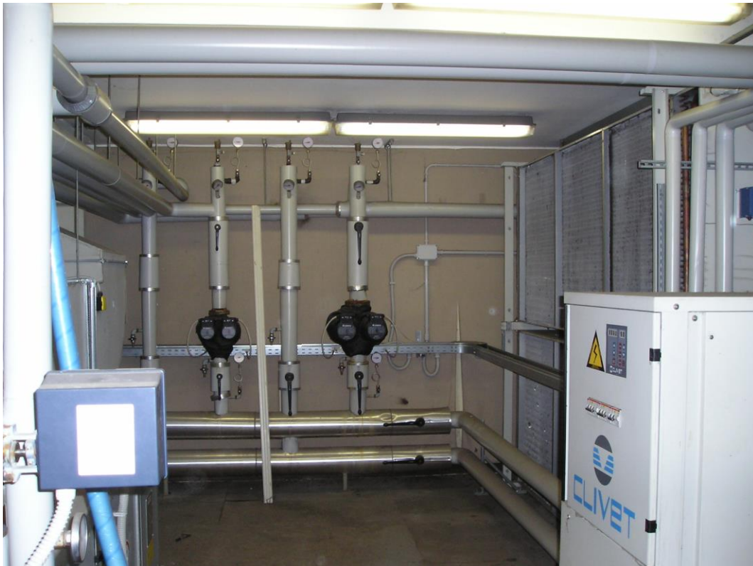
21. La centrale termica della banca, nel sotterraneo
