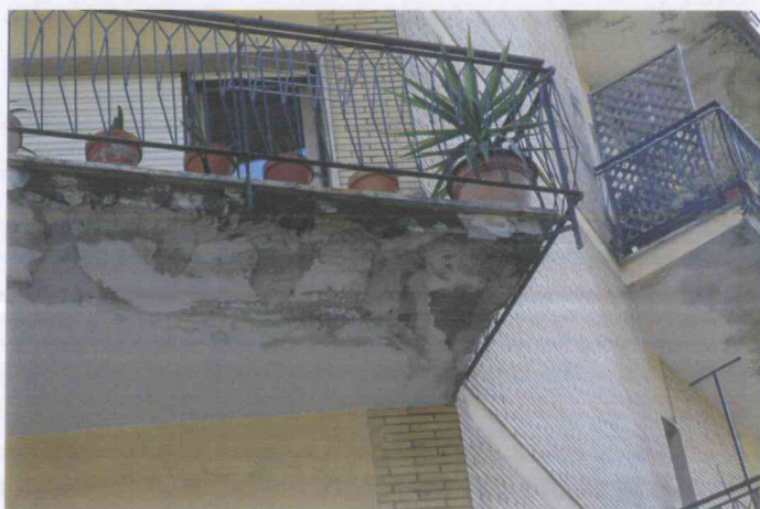
Fig.8 – Facciata esterna _ particolare fotografico che evidenzia le caratteristiche strutturali dei balconi ed i segni di degrado e ammaloramento dell'intonaco e del calcestruzzo nelle solette.
