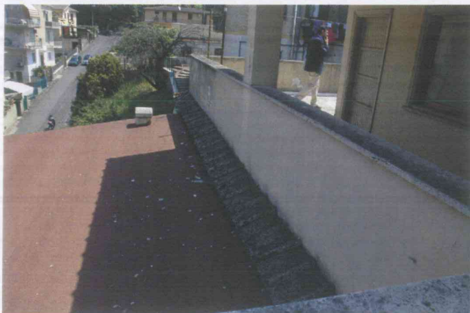
Fig.7 – Copertura del quarto piano _ presenza di elementi in eternit alla base del cornicione.
