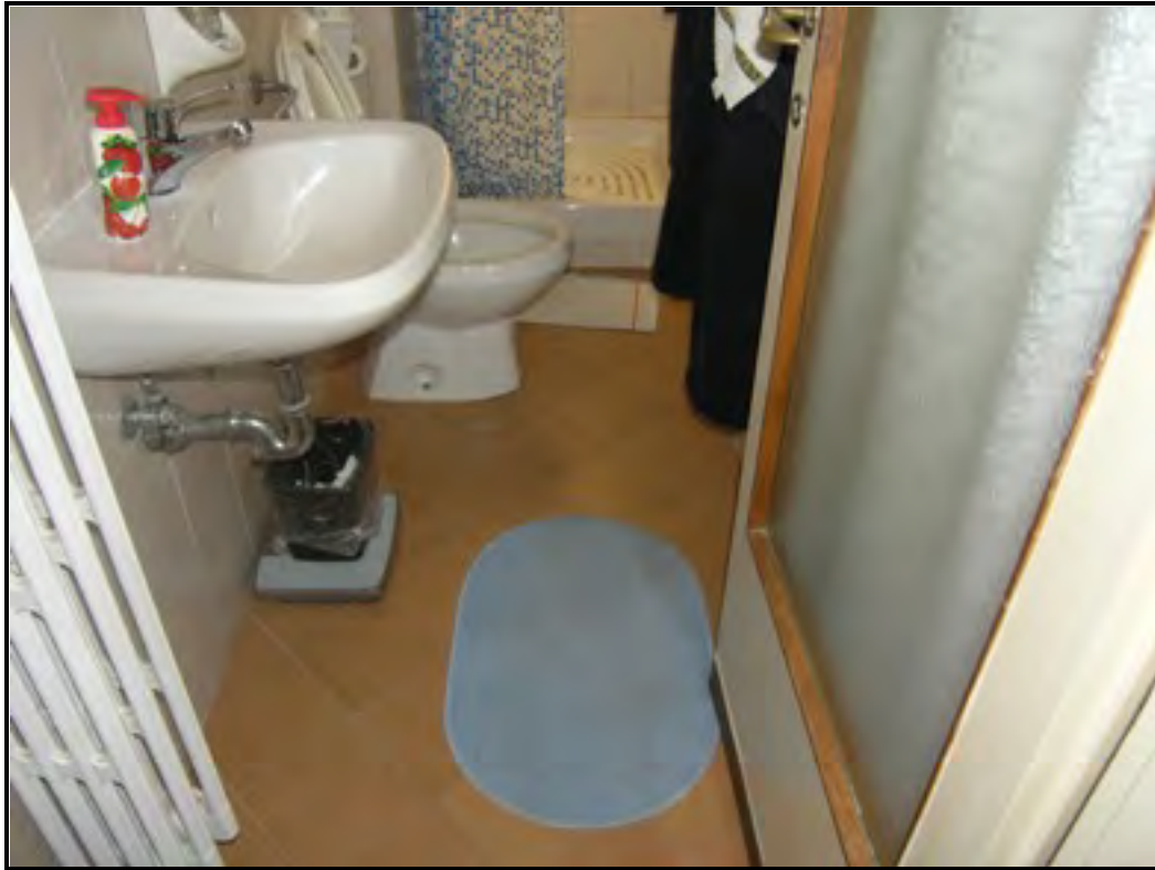
Foto 15 – Secondo bagno – Particolare pavimento e piatto doccia
