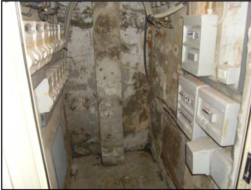
Foto 28 – Vano contatori condominio
