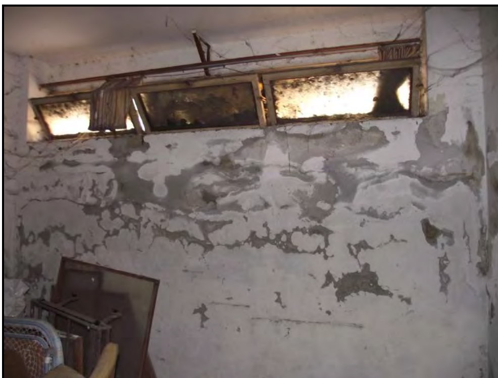
Foto 19 – Deposito - Danni perdita idrica 3
