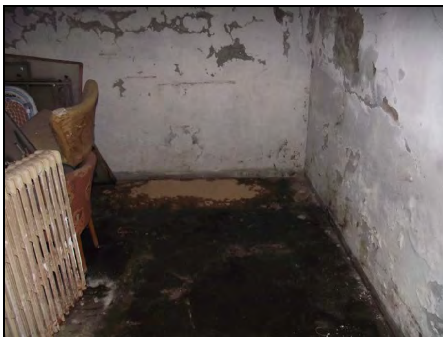
Foto 18 – Deposito - Danni perdita idrica 1
