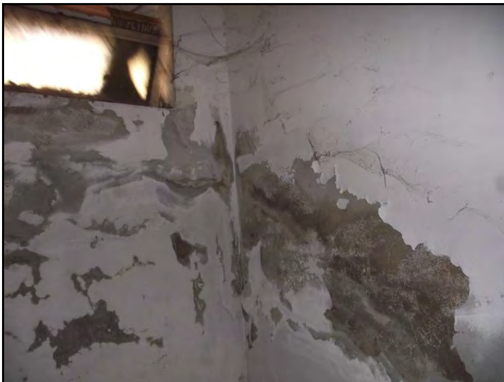
Foto 18 – Deposito - Danni perdita idrica 2
