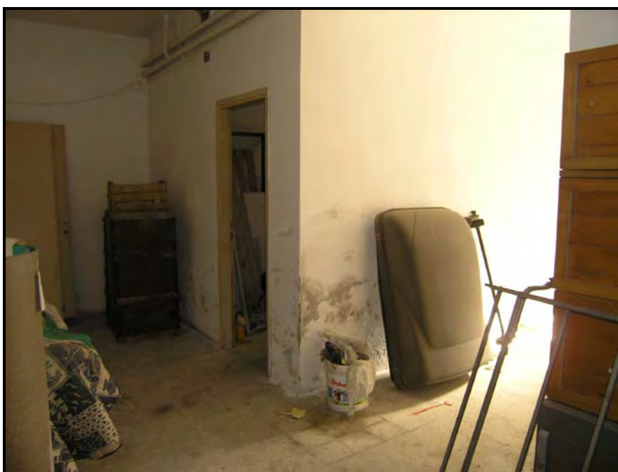
Foto 14 – Locale deposito - Immagine 2
