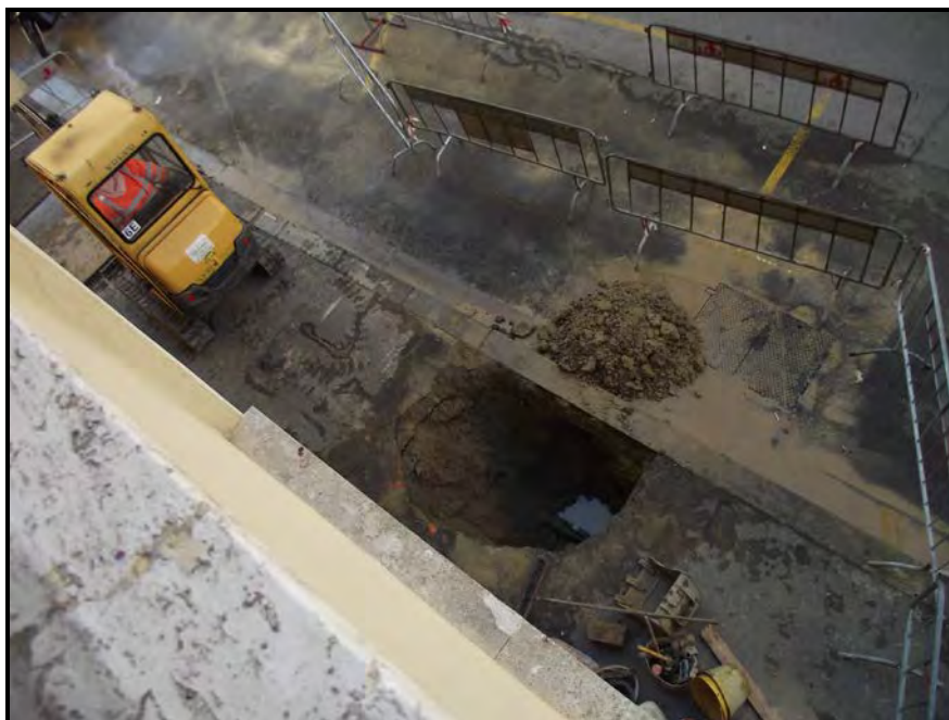
Foto 17 – Perdita idrica in cortile interno
