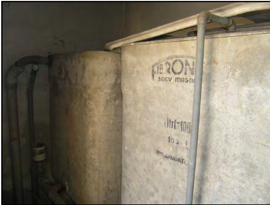
Foto 26 - Ex vaso espansione aperto cemento amianto 1
