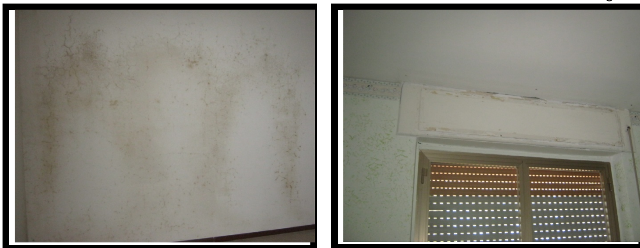
Fig. 23 – Particolare delle infiltrazioni e degli infissi.
