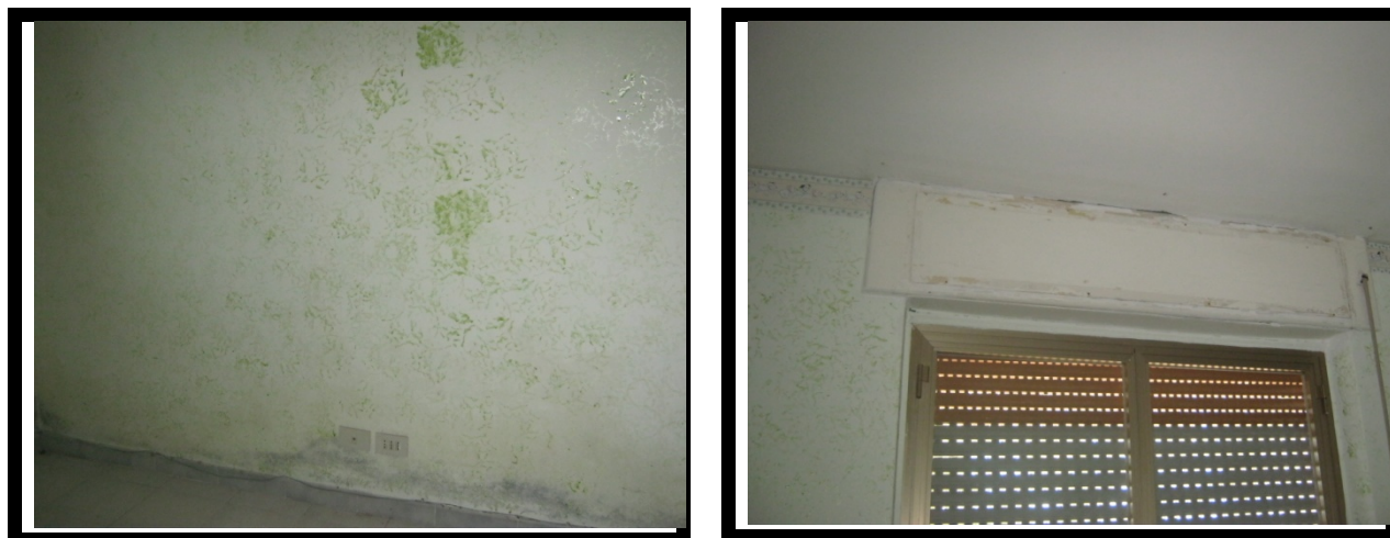
Fig. 23 – Particolare delle infiltrazioni e degli infissi.
