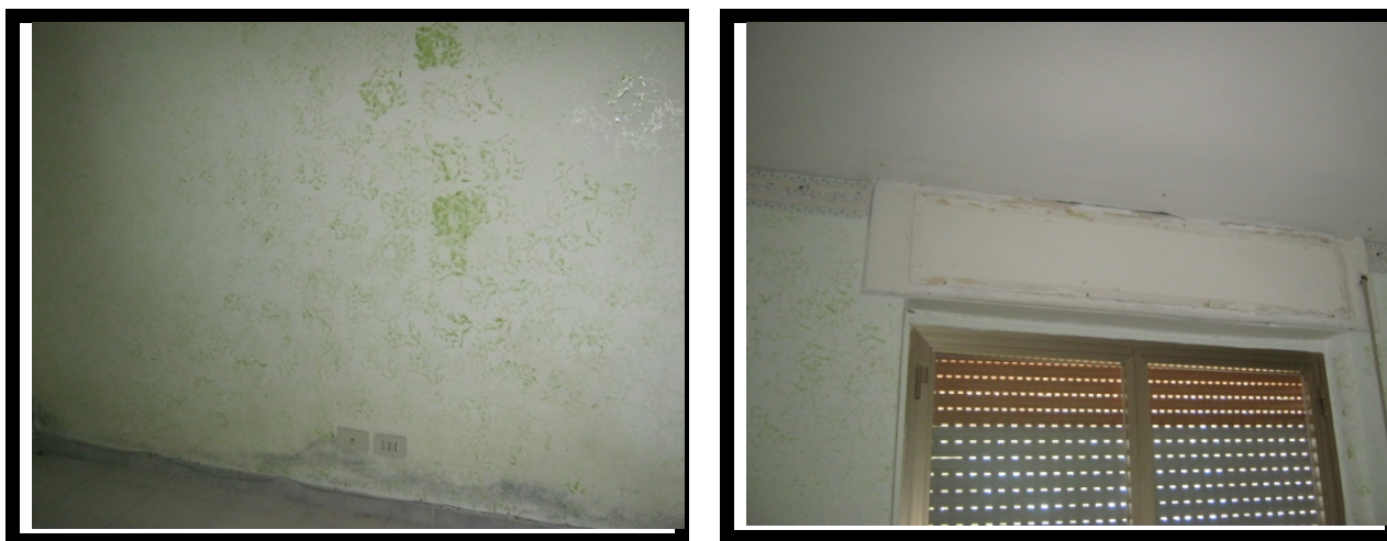
Fig. 23 – Particolare delle infiltrazioni d’acqua e degli infissi.
