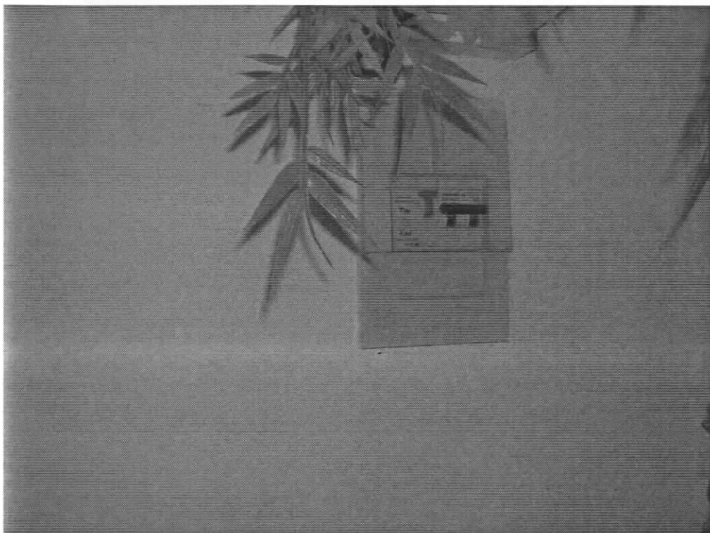
Foto n° 19 – Particolare quadro elettrico alloggio
