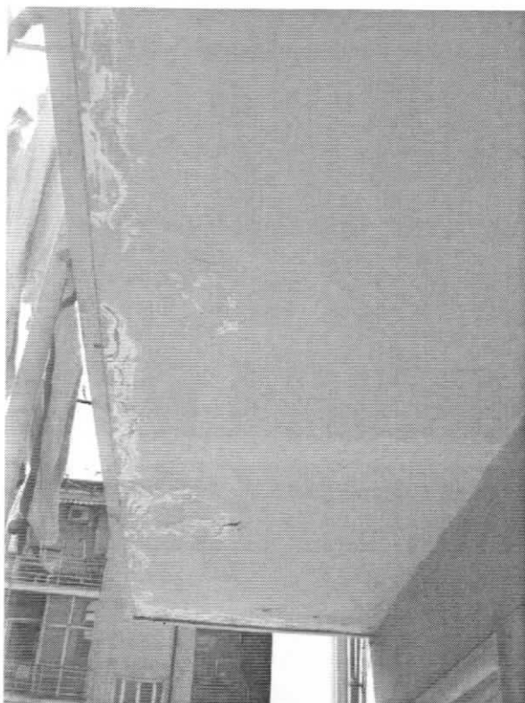
Foto n° 13 – Particolare vetustà intradosso balcone
