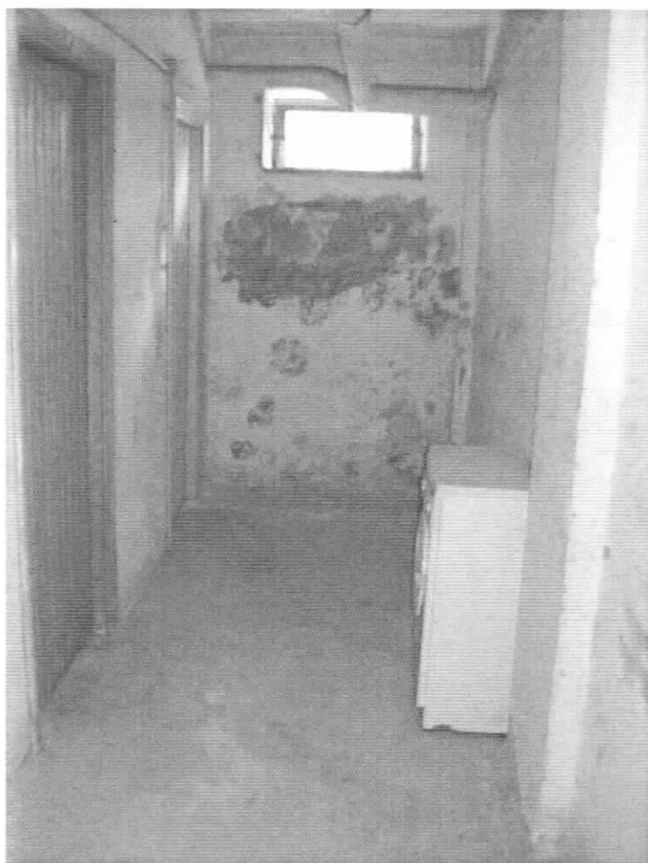
Foto n° 10 – Particolare umidità e infiltrazioni cantinole
