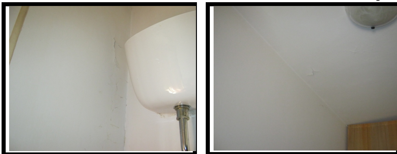
Fig. 23 – Particolare delle infiltrazioni.
