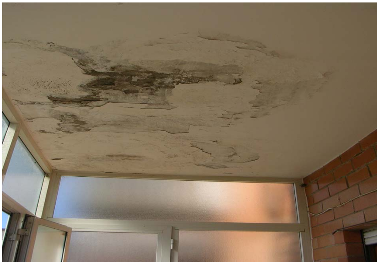
Foto n° 6 – Particolare stato intradossi – frontalini balconi
