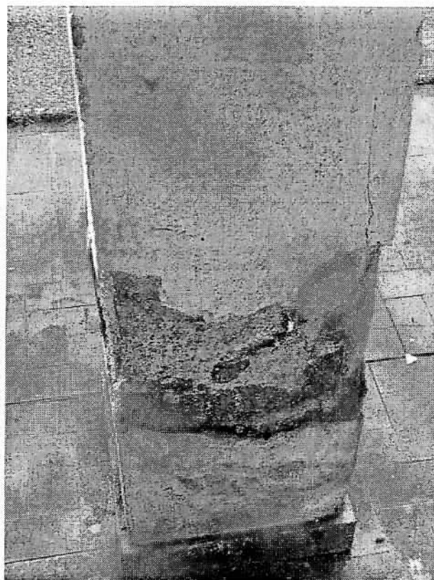
Foto n° 9 – Particolare delle macchie di umidità sui pilastri porticato
