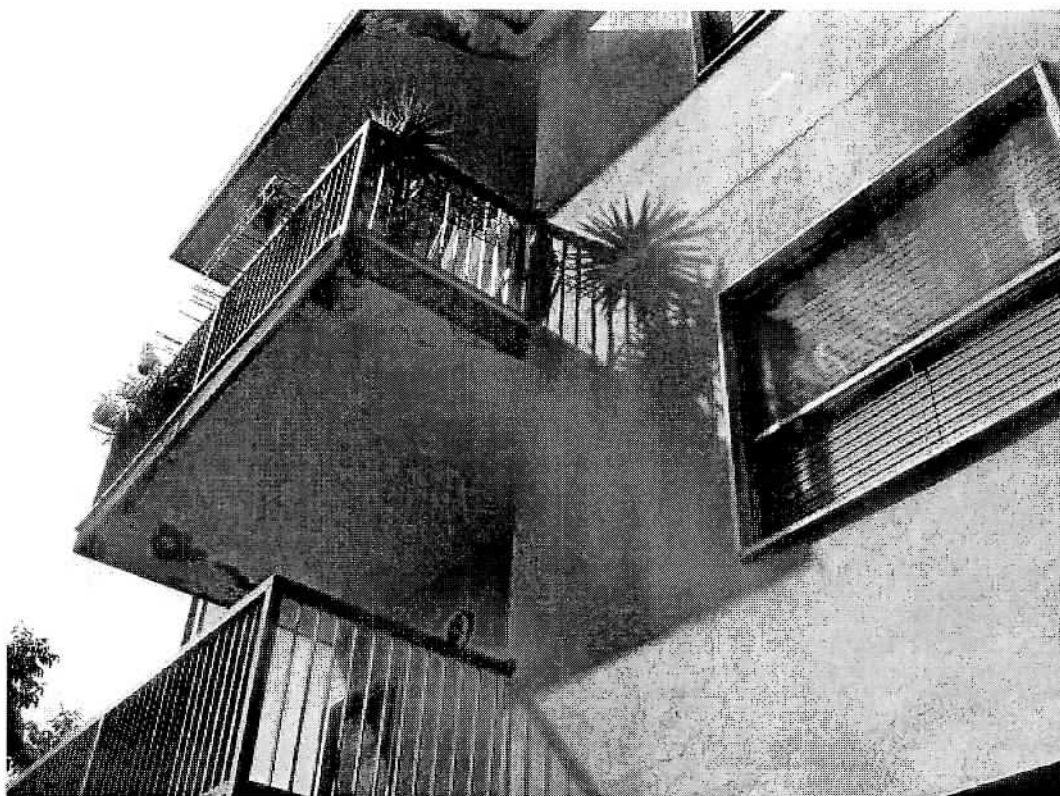
Foto n° 6 – Particolare delle macchie di umidità dovute a infiltrazioni
