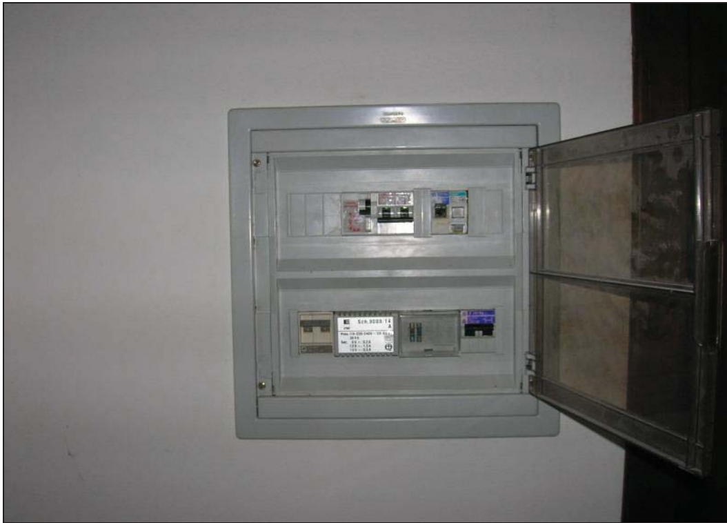
Foto 7 – quadro elettrico dell'appartamento.
