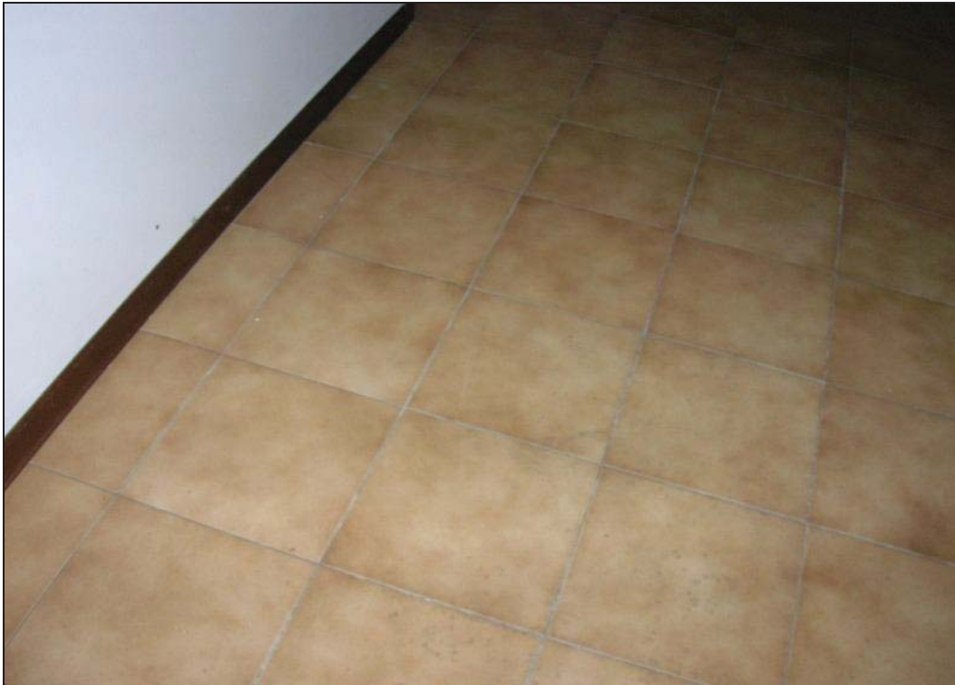
Foto 1 - stato manutentivo pavimentazione delle camere.
