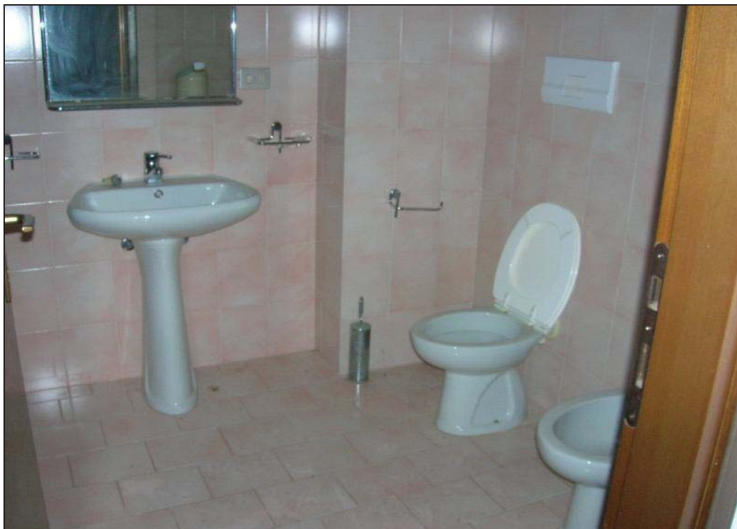
Foto 2 - stato manutentivo pavimentazione bagno.
