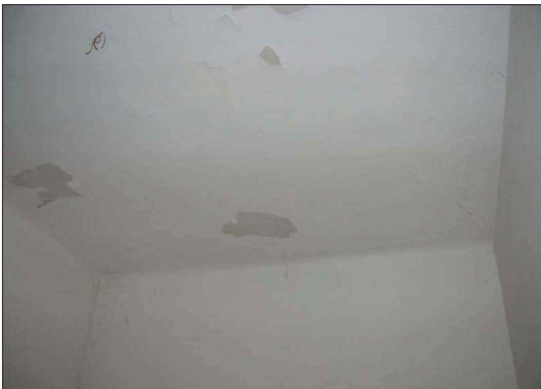
Foto 6 – stato manutentivo pareti e soffitti.
