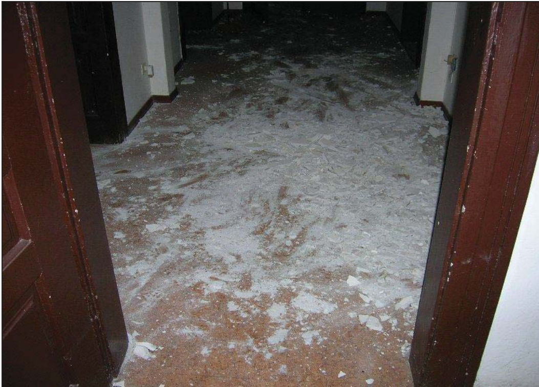
Foto 1 - stato manutentivo pavimentazione dell'ingresso/corridoio.
