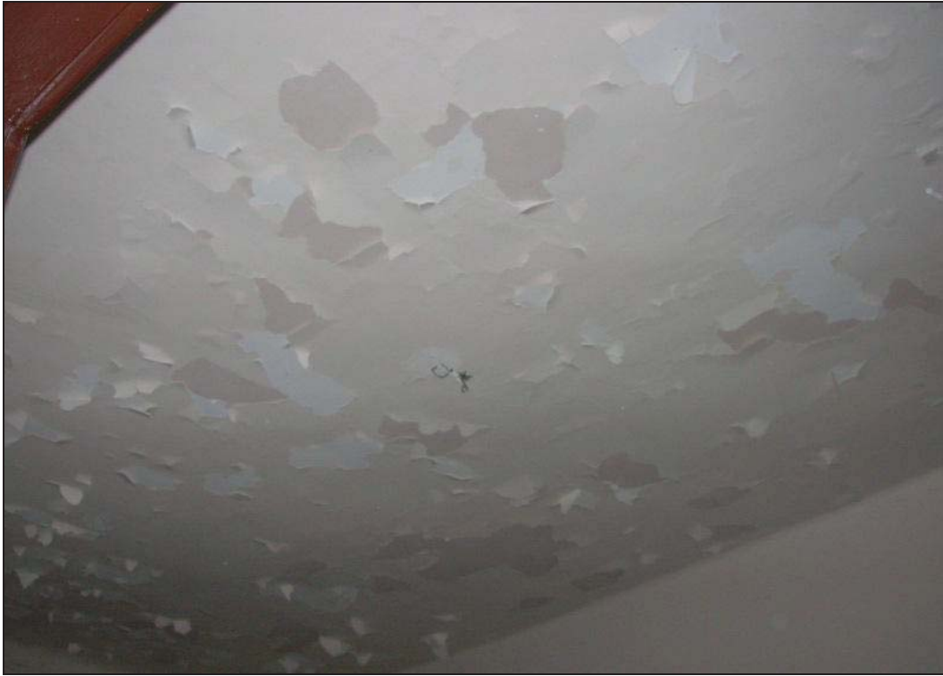
Foto 7 - stato manutentivo pareti e soffitti.
