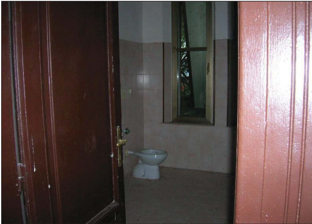
Foto 3 - stato manutentivo pavimentazione bagno.
