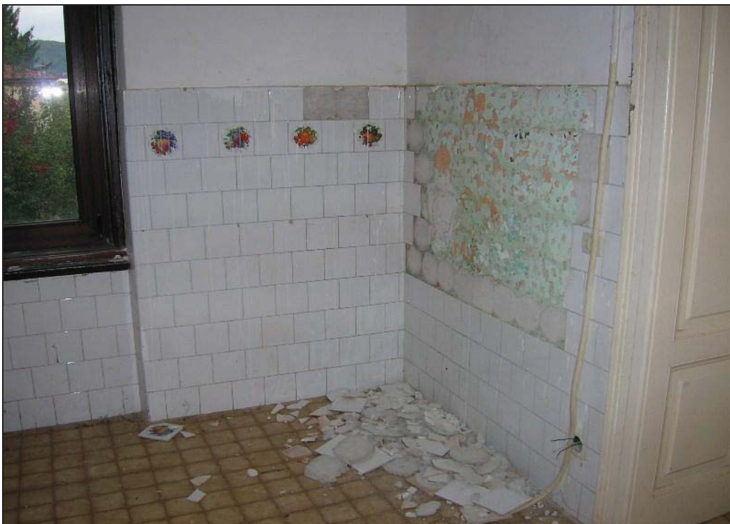
Foto 2 - stato manutentivo pavimentazione locale cucina.
