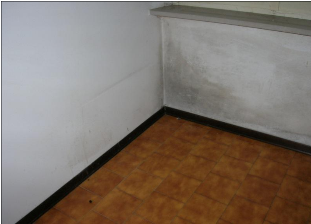
Foto 3 - stato manutentivo pavimentazione e pareti delle camere.
