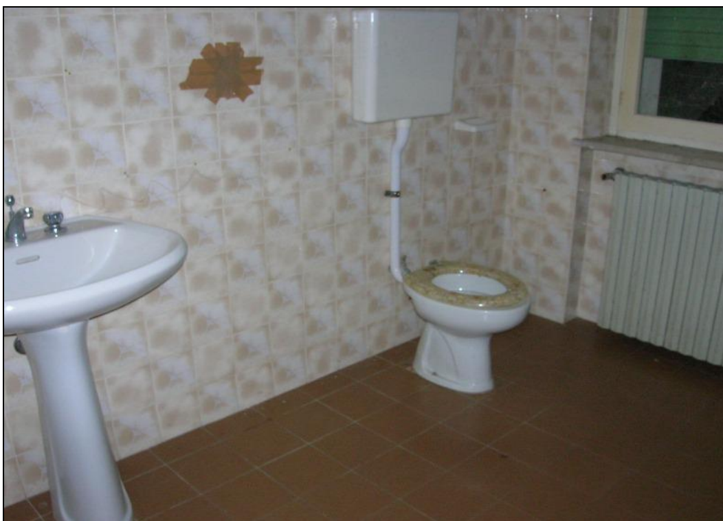
Foto 2 - stato manutentivo pavimentazione bagno.
