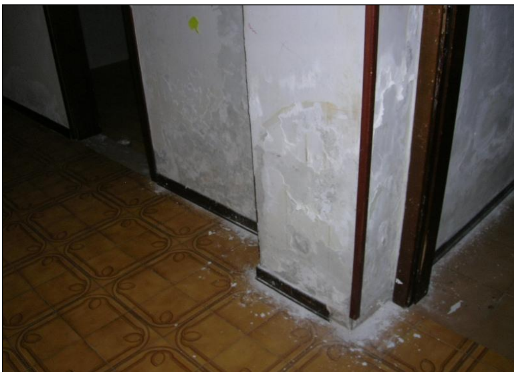
Foto 1 - stato manutentivo pavimentazione e pareti dell'ingresso/corridoio.
