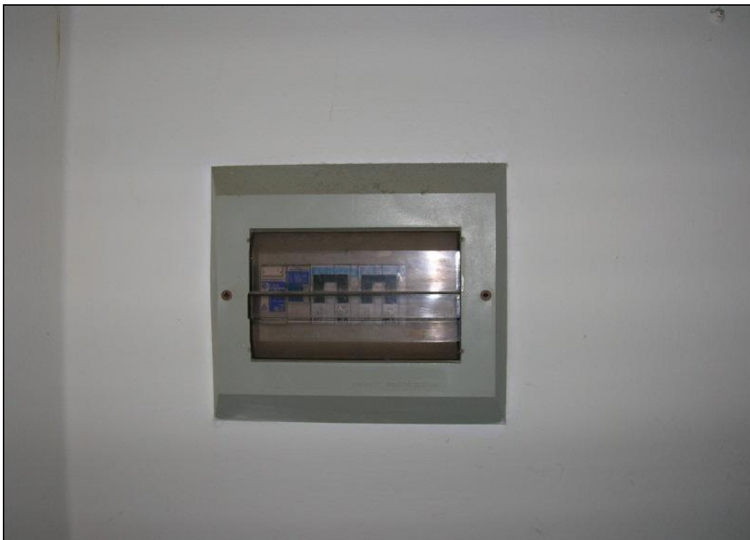
Foto 6 – quadro elettrico dell'unità immobiliare.
