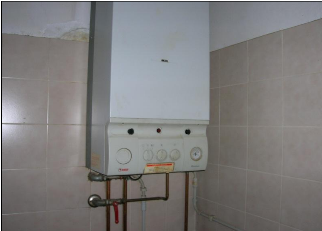
Foto 7 - caldaia dell'impianto di riscaldamento autonomo a metano.
