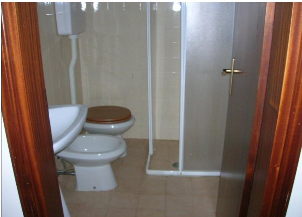
Foto 2 - stato manutentivo pavimentazione del bagno
