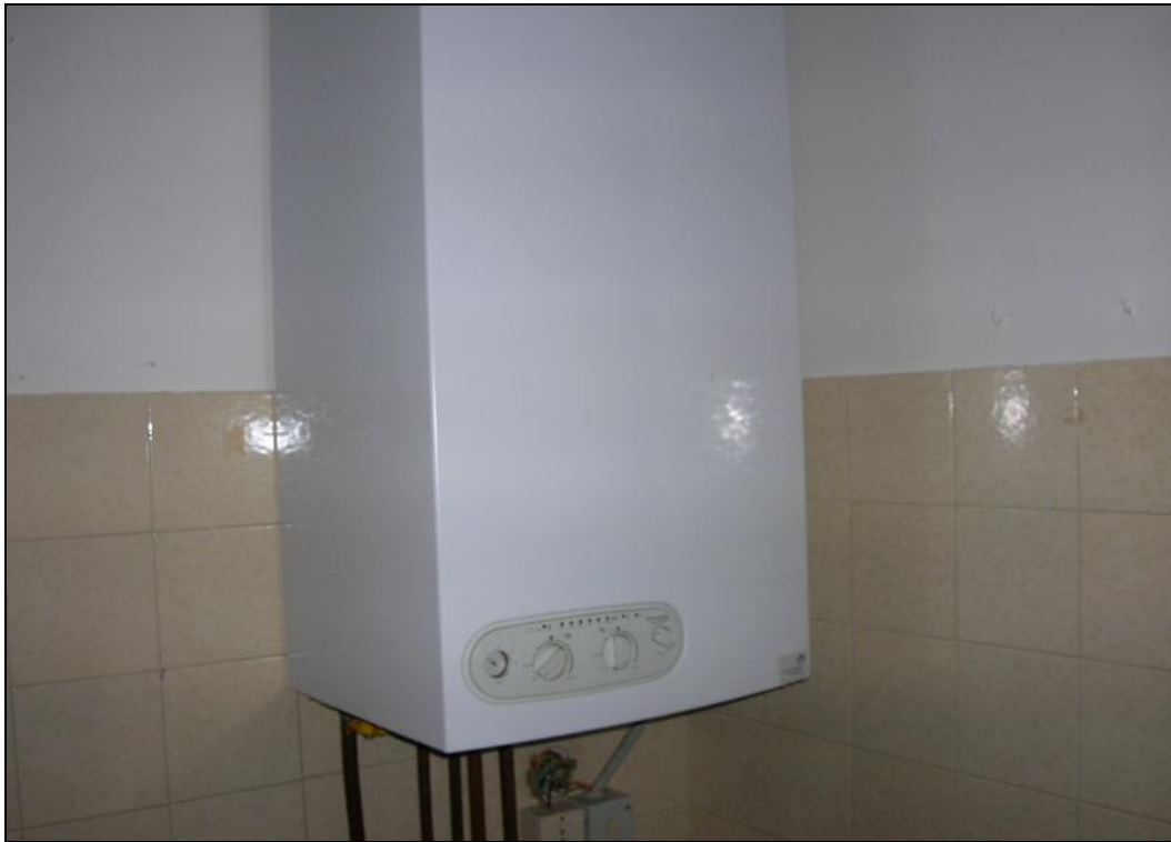
Foto 7 - caldaia dell'impianto di riscaldamento autonomo a metano.
