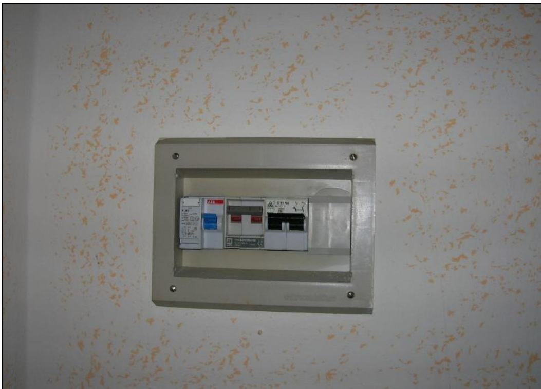
Foto 6 – quadro elettrico dell'unità immobiliare.
