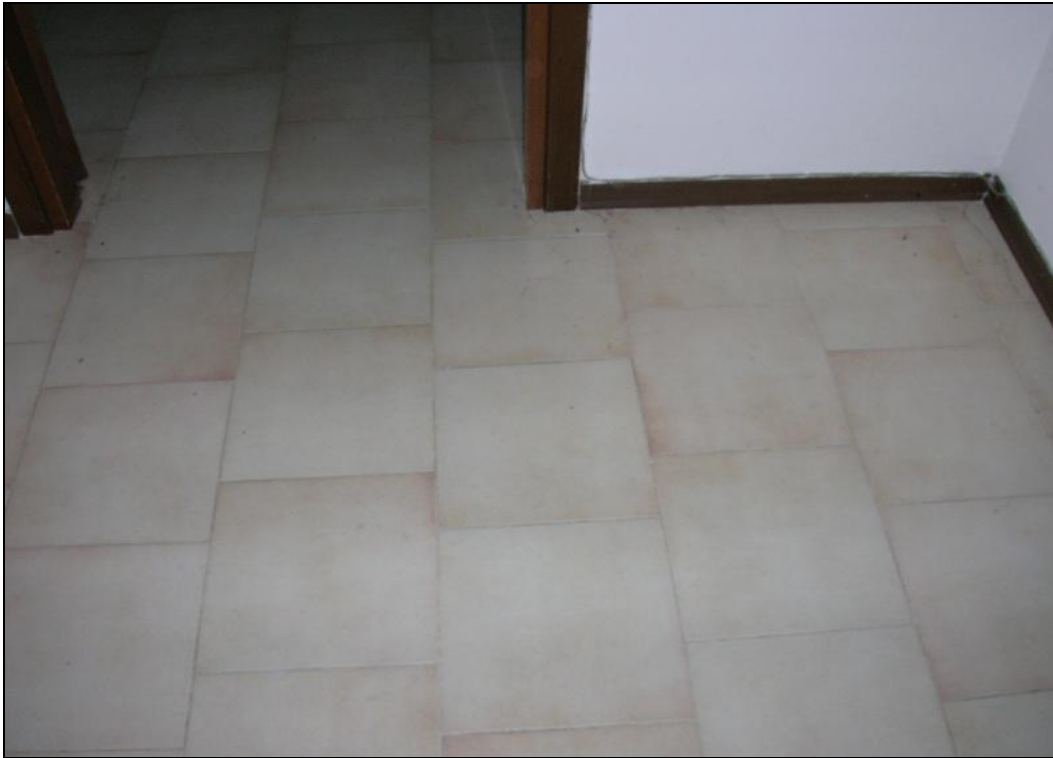
Foto 1 - stato manutentivo pavimentazione dell'ingresso/corridoio.
