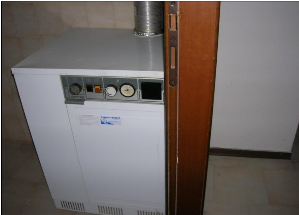
Foto 7 - caldaia dell'impianto di riscaldamento autonomo a metano.
