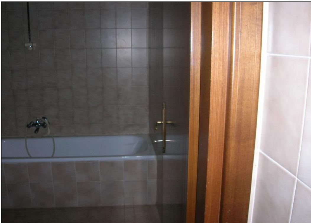
Foto 2 - stato manutentivo pavimentazione bagno
