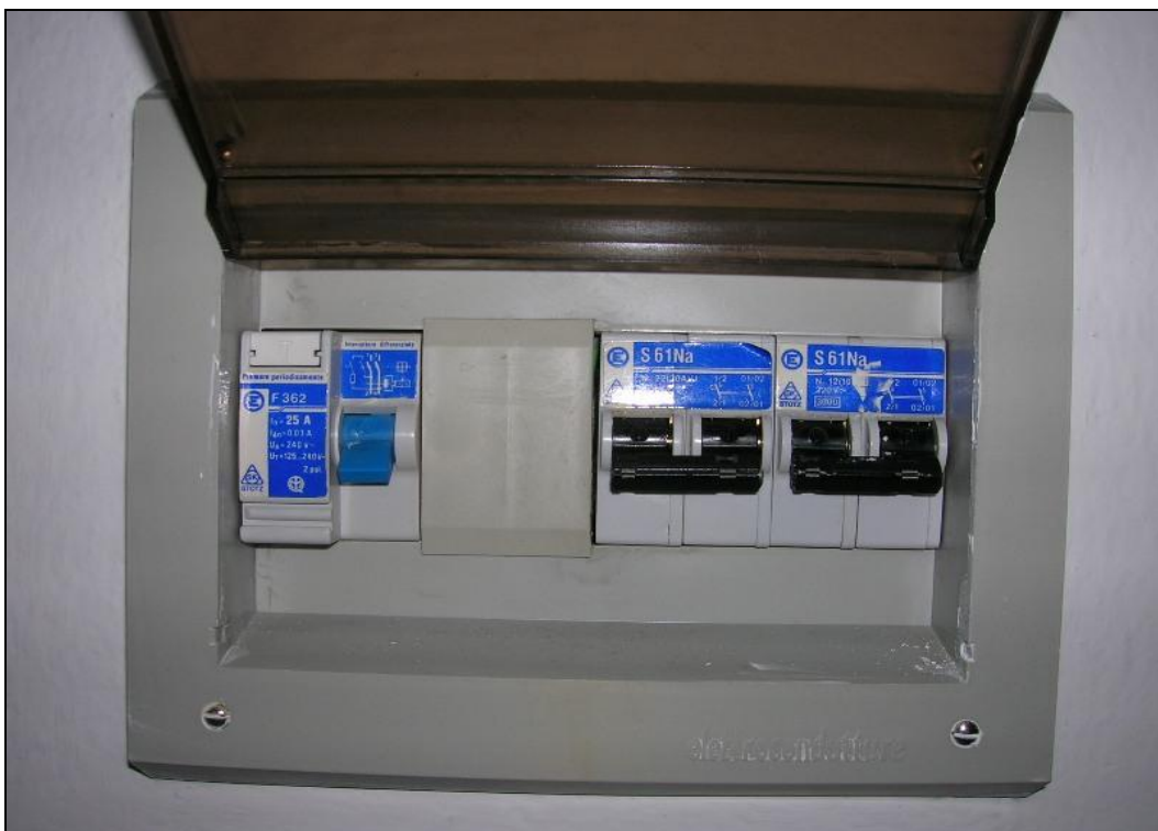
Foto 6 – quadro elettrico dell'unità immobiliare.
