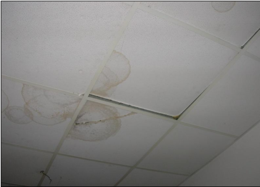
Foto 3 - stato manutentivo controsoffitto dell'appartamento.
