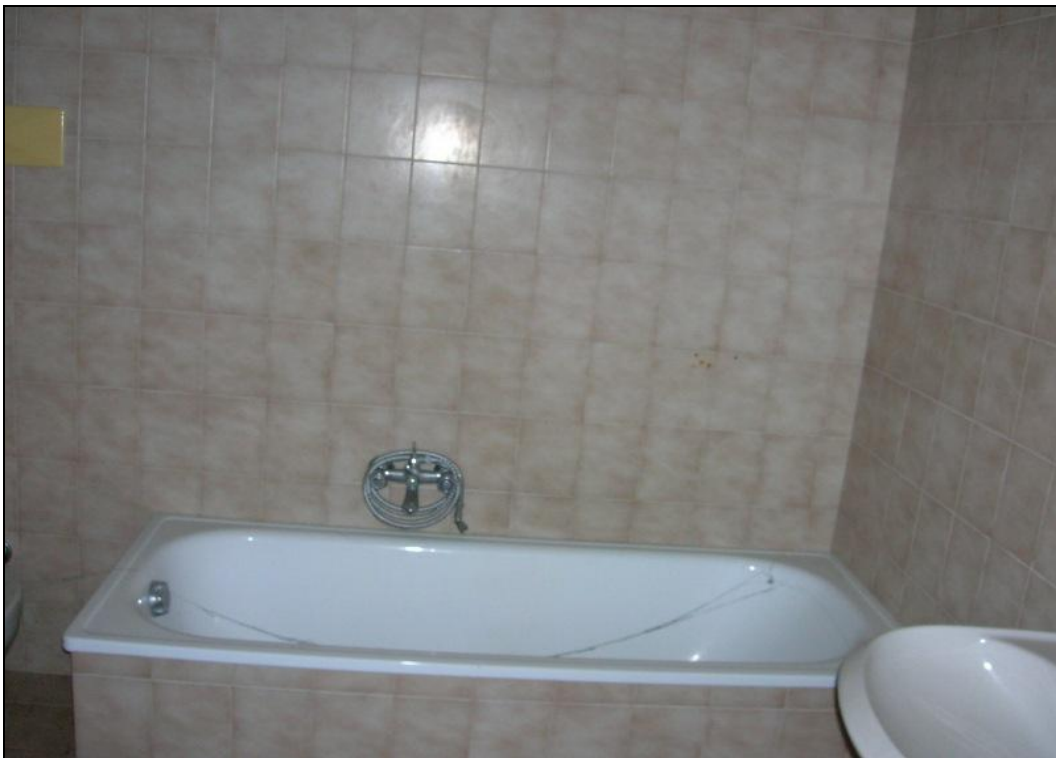
Foto 2 - stato manutentivo pavimentazione del bagno.
