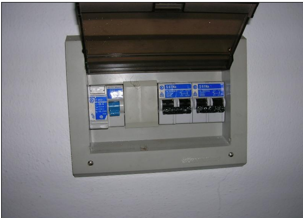
Foto 6 – quadro elettrico dell'unità immobiliare.
