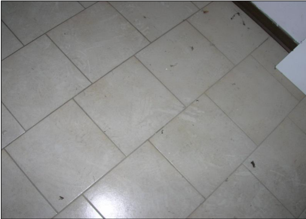
Foto 1 - stato manutentivo pavimentazione dell'ingresso/corridoio.
