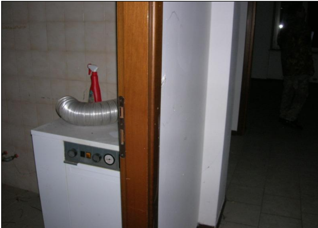
Foto 7 - caldaia dell'impianto di riscaldamento autonomo a metano.
