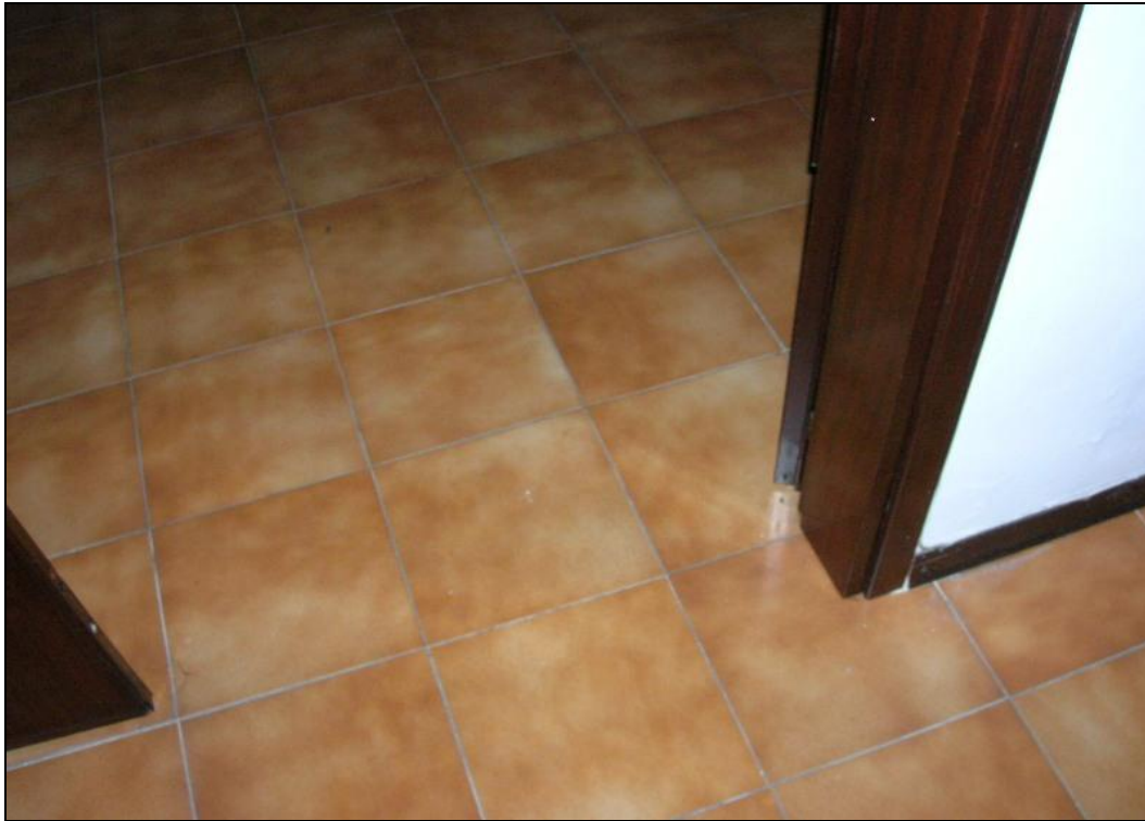
Foto 1 - stato manutentivo pavimentazione dell'ingresso/corridoio.
