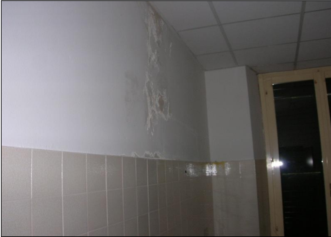
Foto 3 - stato manutentivo parete del secondo bagno dell'appartamento.
