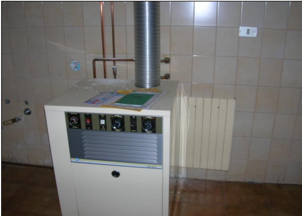
Foto 7 - caldaia dell'impianto di riscaldamento autonomo a metano.
