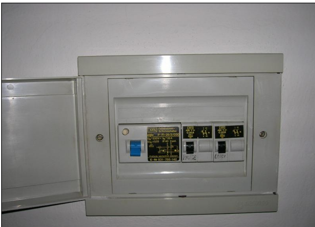
Foto 6 – quadro elettrico dell'unità immobiliare.
