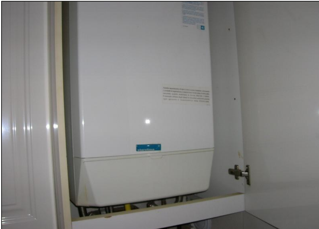
Foto 7 - caldaia dell'impianto di riscaldamento autonomo a metano.
