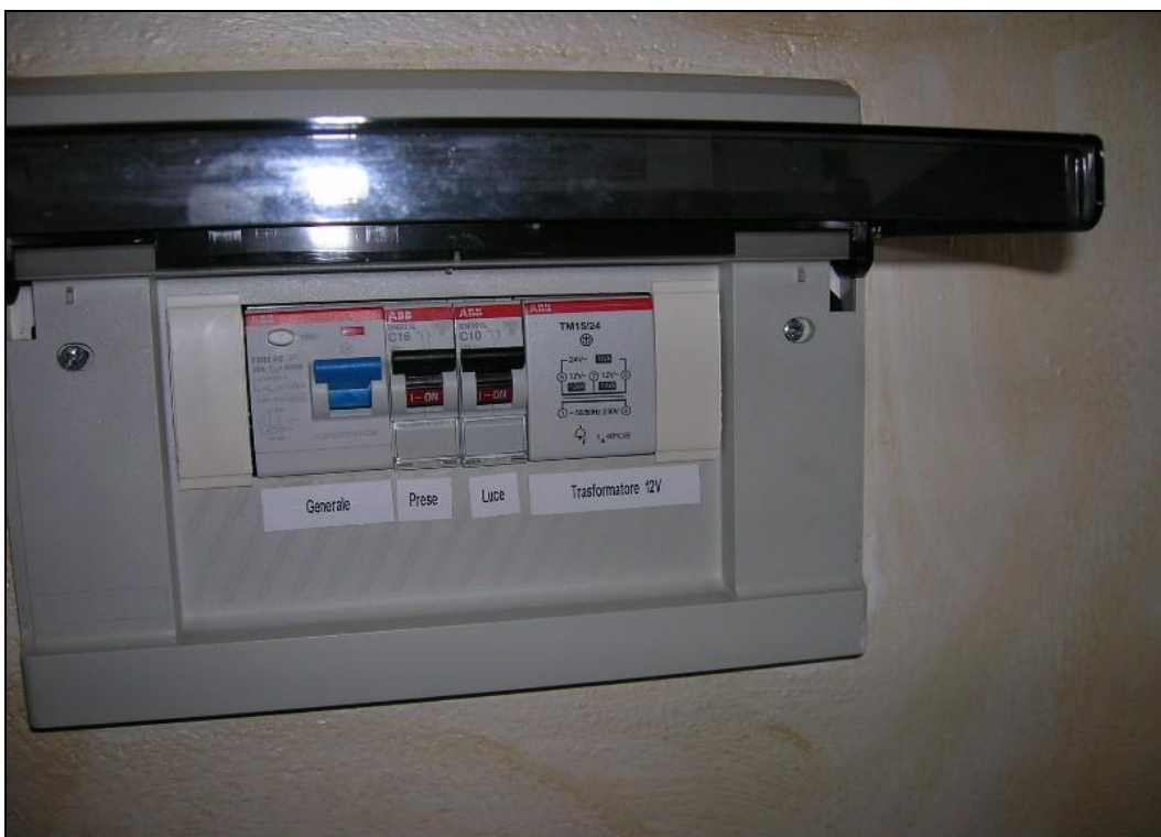
Foto 6 – quadro elettrico dell'unità immobiliare.
