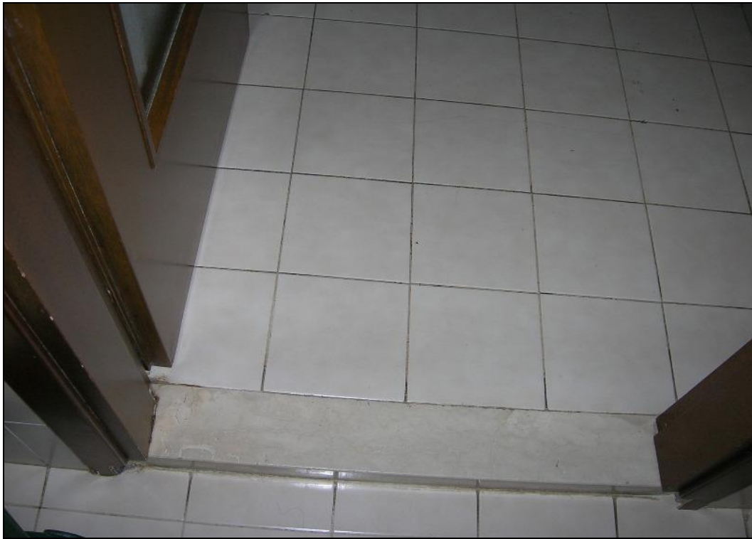
Foto 3 - stato manutentivo pavimentazione corridoio/camere.
