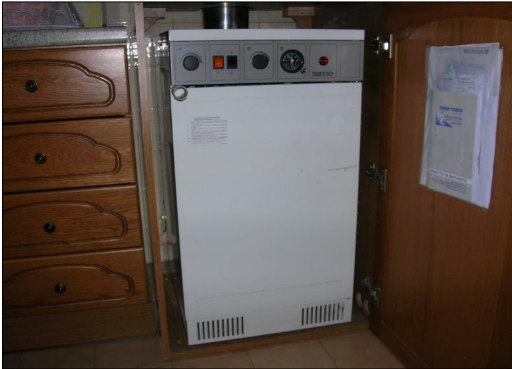
Foto 7 - caldaia dell'impianto di riscaldamento autonomo a metano.
