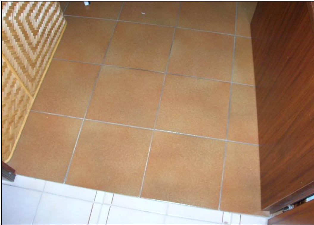
Foto 3 - stato manutentivo pavimento corridoio e camera
