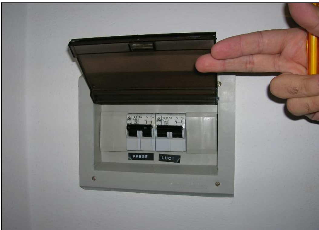
Foto 6 – quadro elettrico dell'unità immobiliare.
