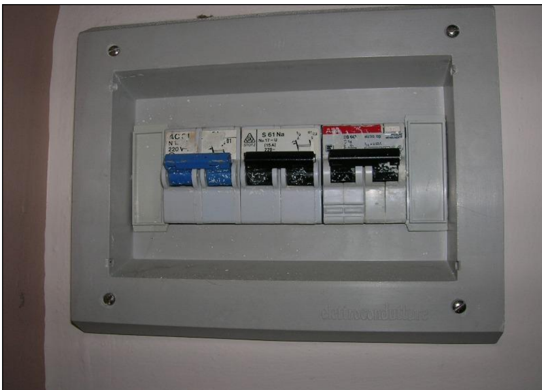
Foto 6 – quadro elettrico dell'unità immobiliare.
