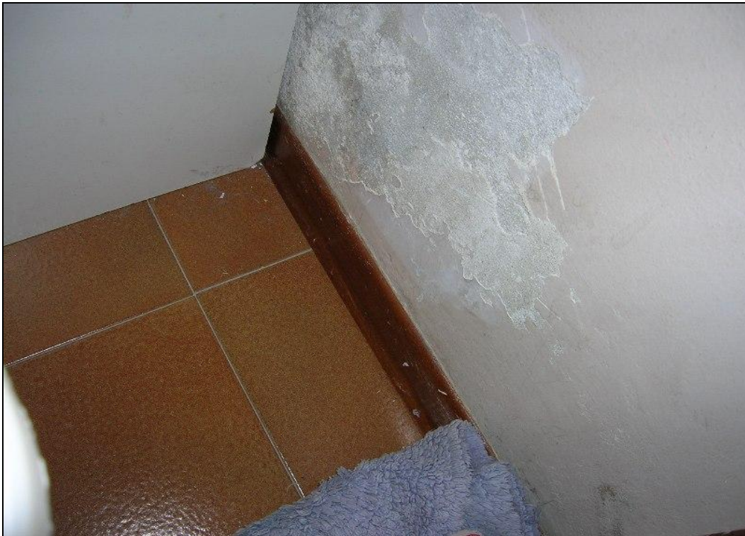
Foto 3 - stato manutentivo pavimento e parete camera
