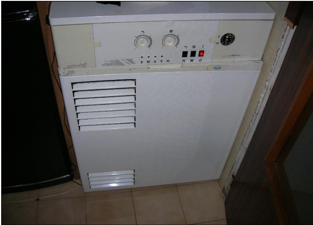
Foto 7 - caldaia dell'impianto di riscaldamento autonomo a metano.
