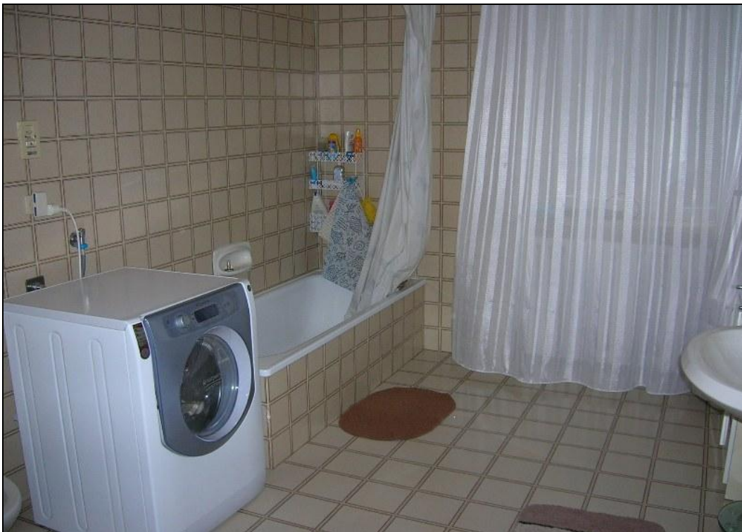
Foto 2 - stato manutentivo pavimentazione bagno.
