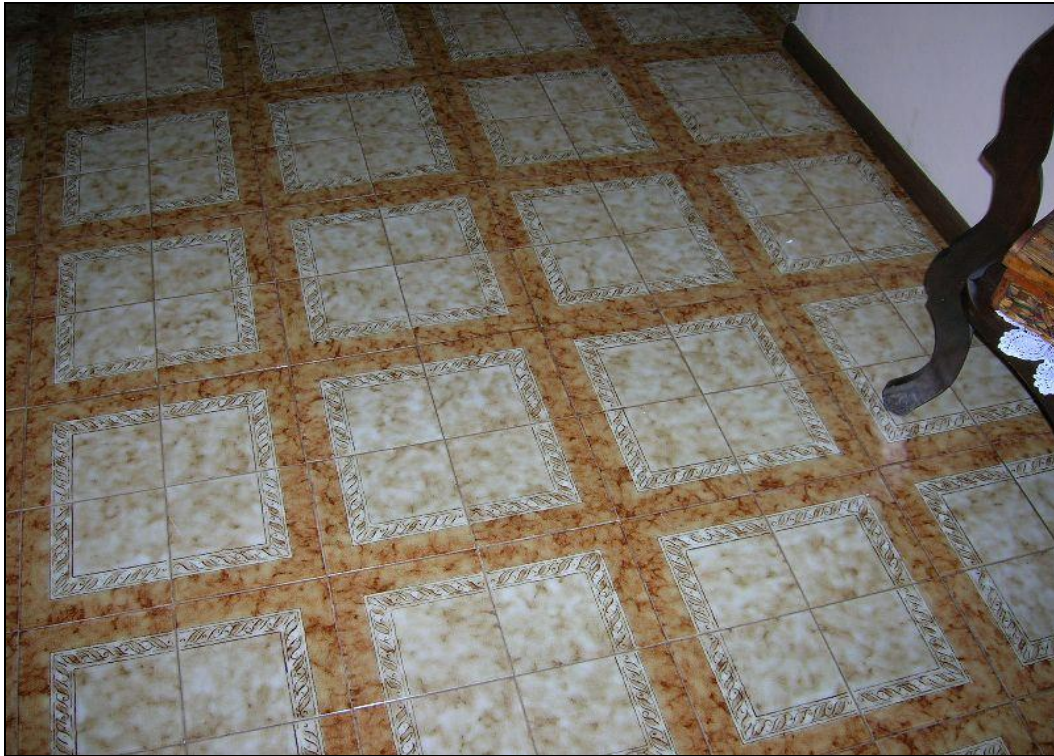
Foto 1 - stato manutentivo pavimentazione dell'ingresso/corridoio.
