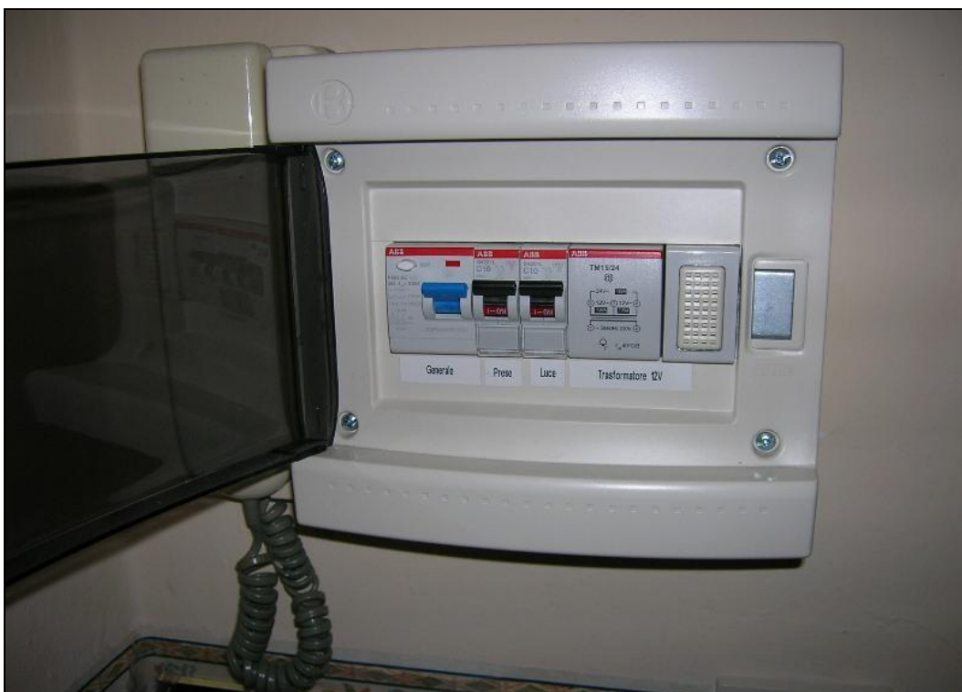
Foto 6 – quadro elettrico dell'unità immobiliare.
