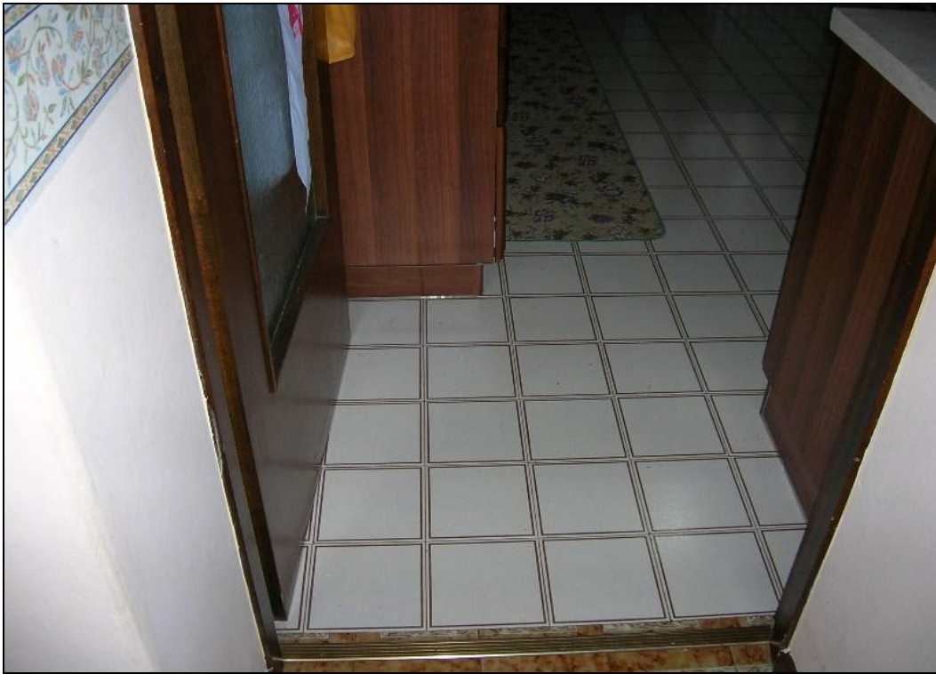
Foto 3 - stato manutentivo pavimentazione del corridoio/cucina.
