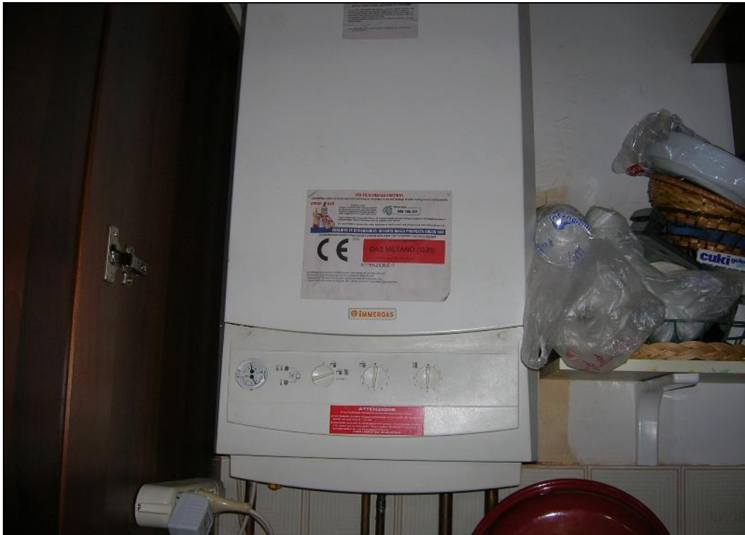
Foto 7 - caldaia dell'impianto di riscaldamento autonomo a metano.
