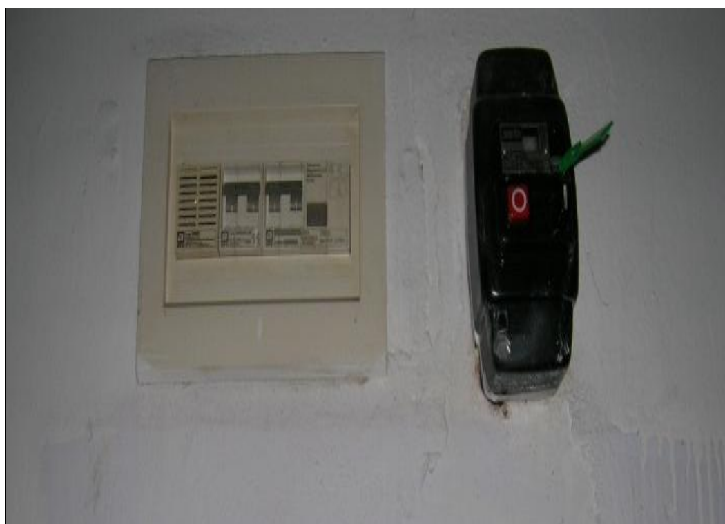
Foto 6 – quadro elettrico dell'unità immobiliare (impianto elettrico non a norma).
