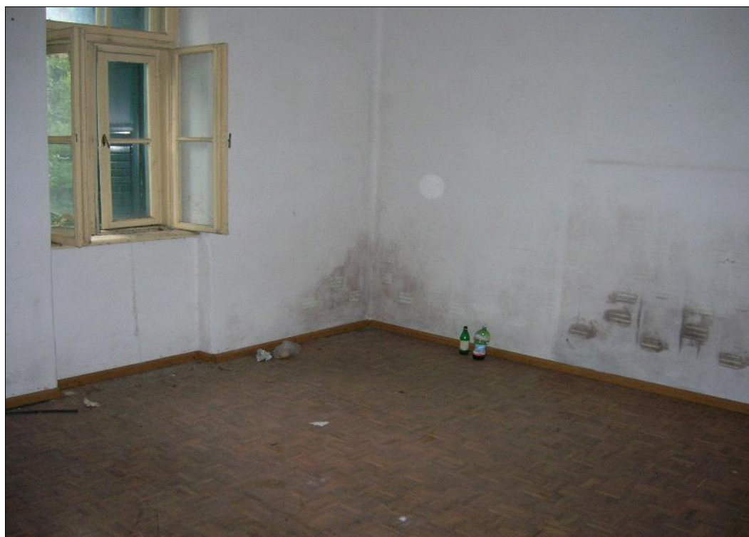
Foto 2 - stato manutentivo pavimentazione camere.
