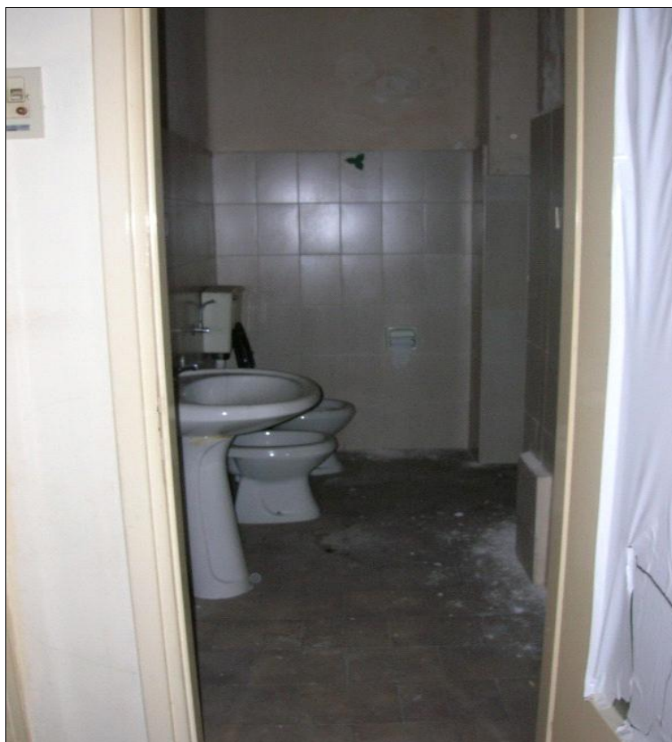
Foto 3 - stato manutentivo pavimentazione del bagno.
