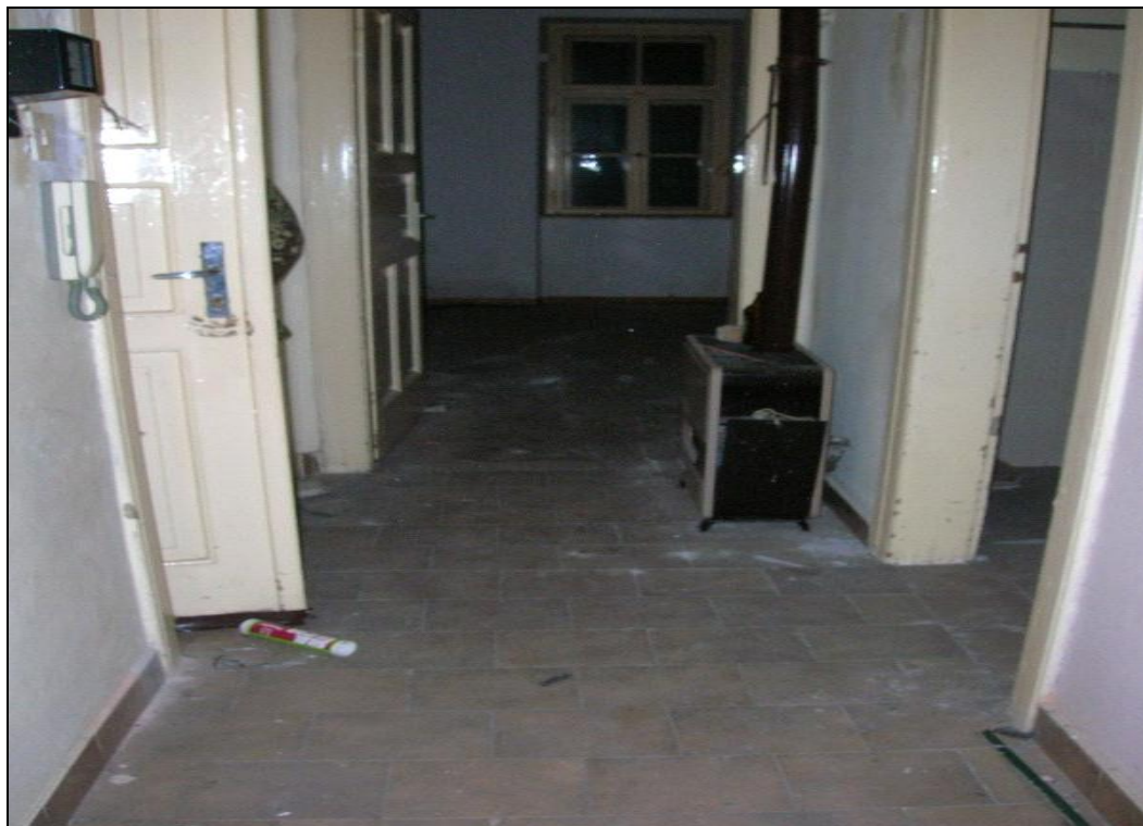
Foto 1 - stato manutentivo pavimentazione dell'ingresso / corridoio e soggiorno.
