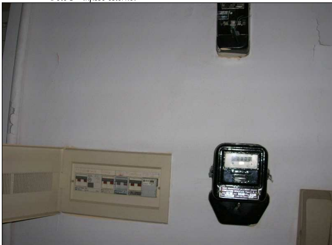
Foto 6 – quadro elettrico unità immobiliare.
