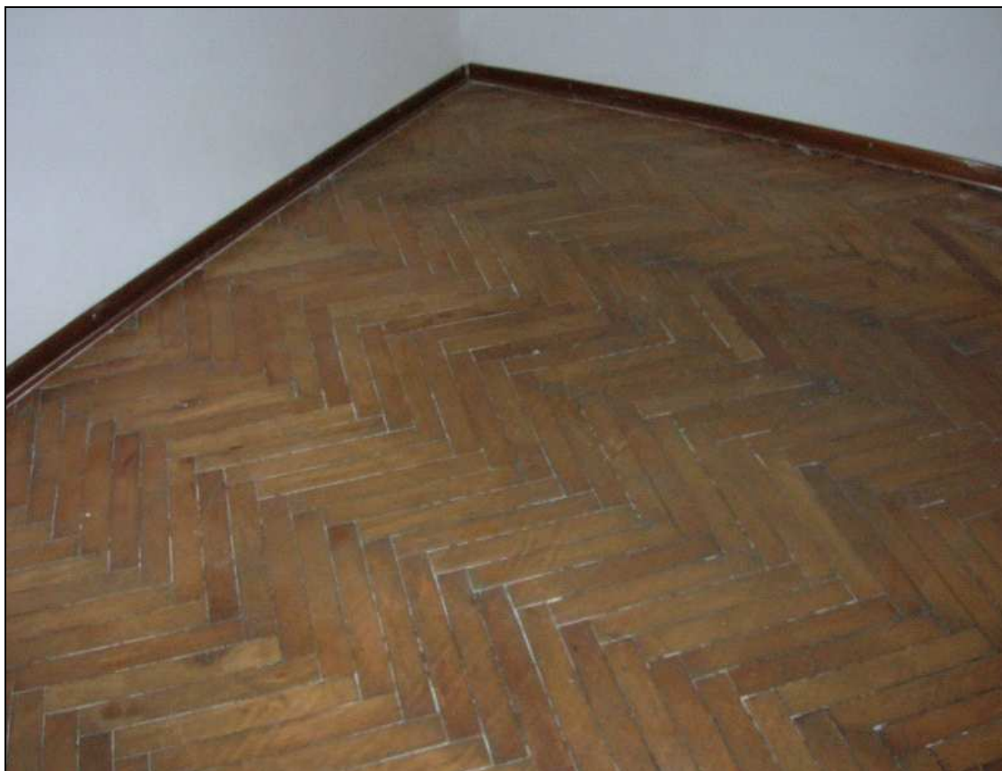
Foto 2 - stato manutentivo pavimentazione e pareti delle camere.
