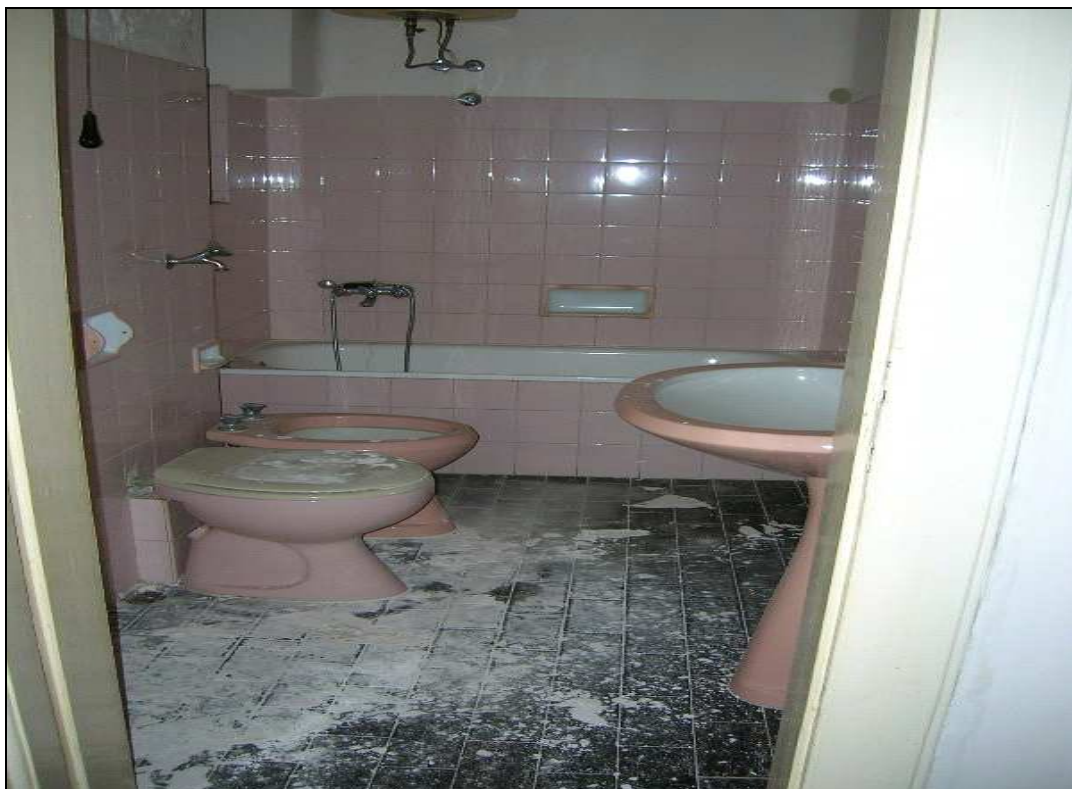
Foto 3 - stato manutentivo pavimentazione del bagno.
