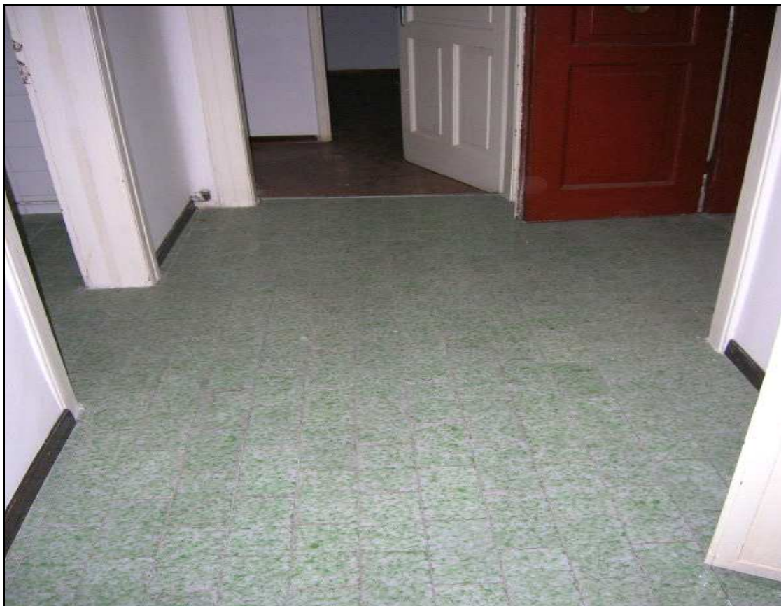
Foto 1 - stato manutentivo pavimentazione dell'ingresso / corridoio e soggiorno.
