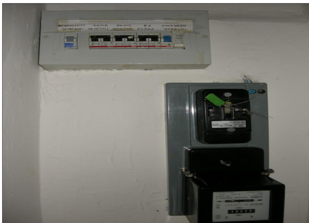
Foto 6 – quadro elettrico unità immobiliare.
