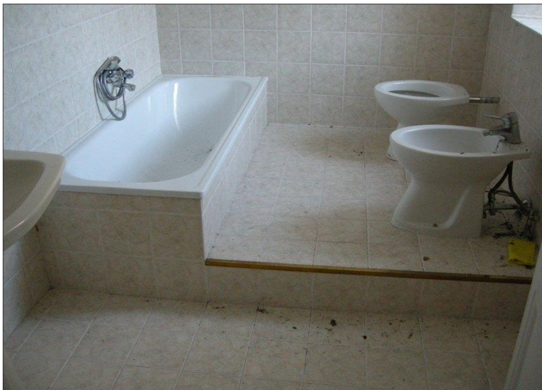
Foto 2 - stato manutentivo pavimentazione del bagno.
