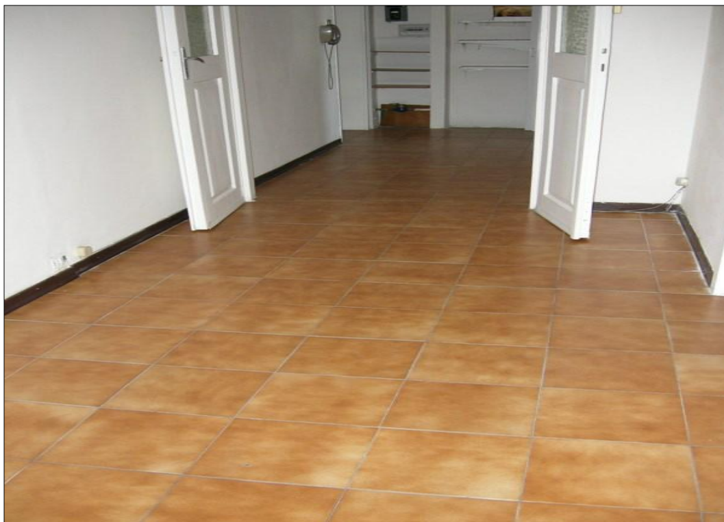
Foto 1 - stato manutentivo pavimentazione dell'ingresso / corridoio e soggiorno.
