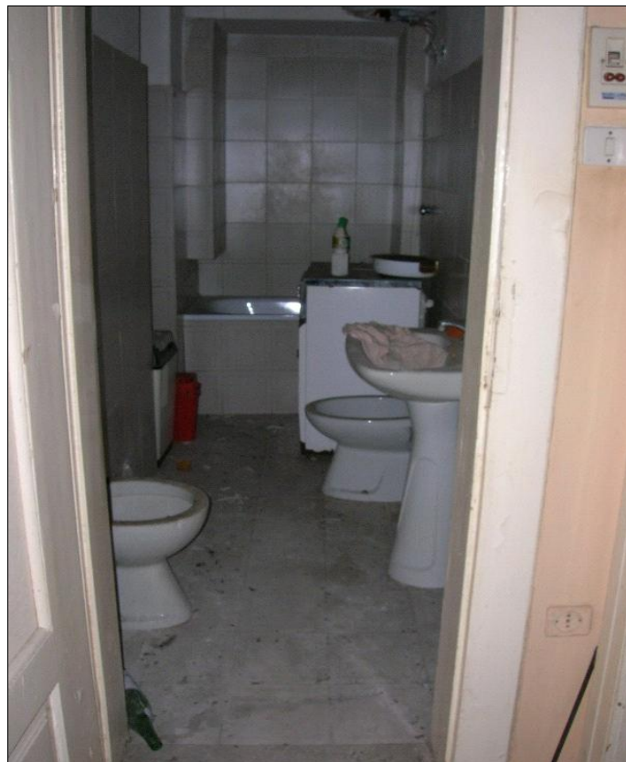
Foto 3 - stato manutentivo pavimentazione del bagno.
