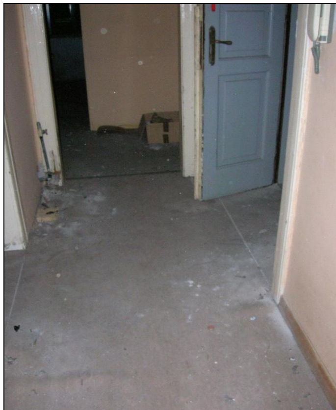
Foto 1 - stato manutentivo pavimentazione dell'ingresso / corridoio.
