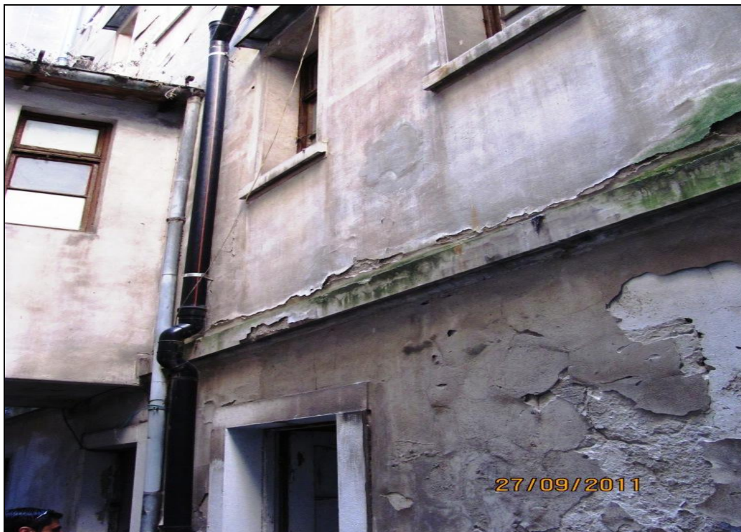
Foto 10 – Particolare fotografico dal quale si evince il degrado generale cortile interno.
