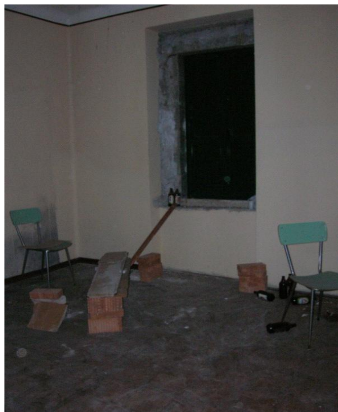
Foto 2 - stato manutentivo pavimentazione camere.
