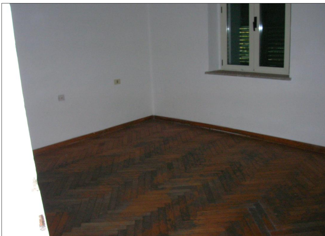
Foto 2 - stato manutentivo pavimentazione camere.
