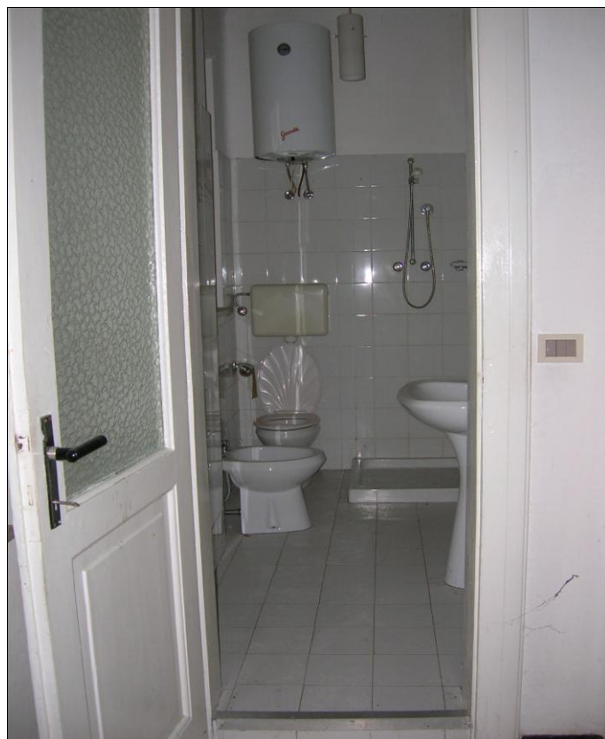
Foto 3 - stato manutentivo pavimentazione del bagno.
