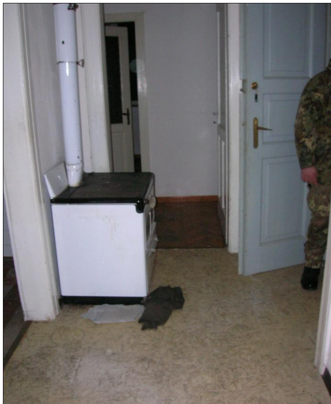
Foto 1 - stato manutentivo pavimentazione dell'ingresso / corridoio.
