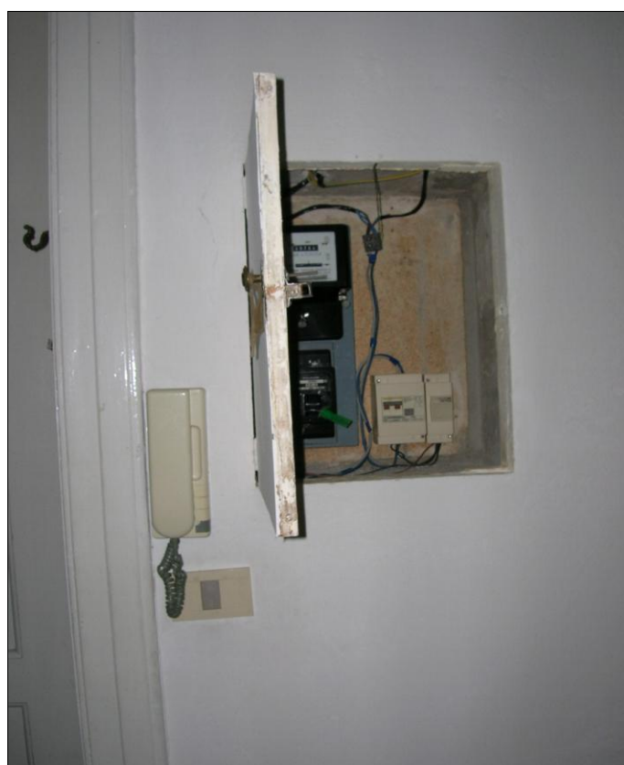
Foto 6 – quadro elettrico dell'unità immobiliare (impianto elettrico non a norma).
