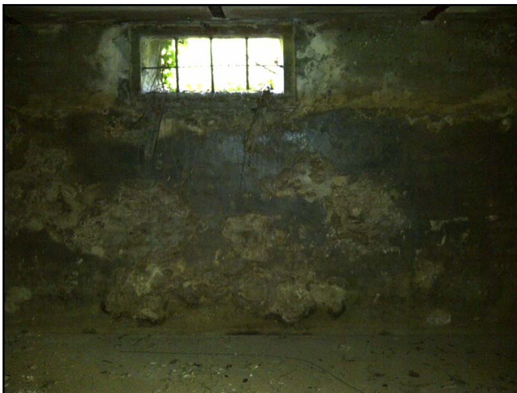
Foto 16 – Piano Interrato. Cantina - Intonaci in pessimo stato di manutenzione
