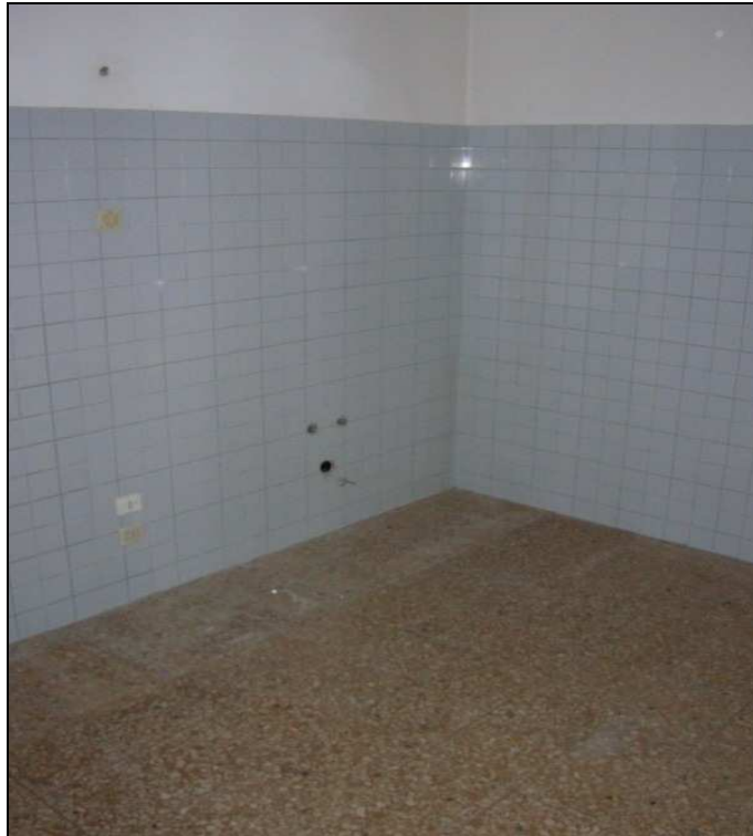
Foto 1: stato manutentivo pavimentazioni e rivestimenti cucina.
