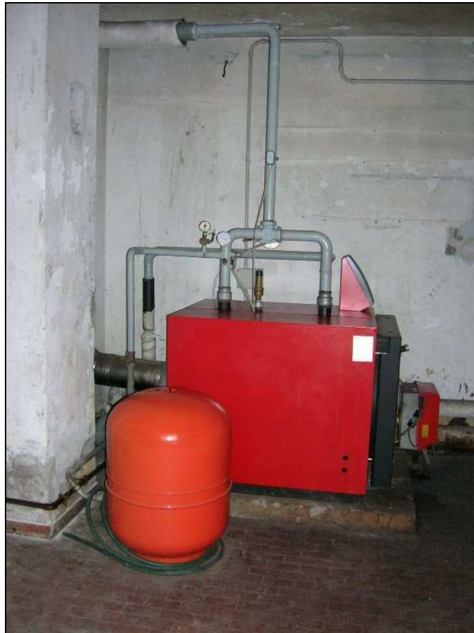
Foto 7: centrale termica centralizzata.
