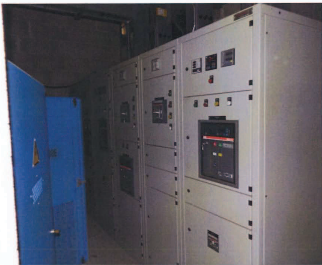
Quadro elettrico generale
