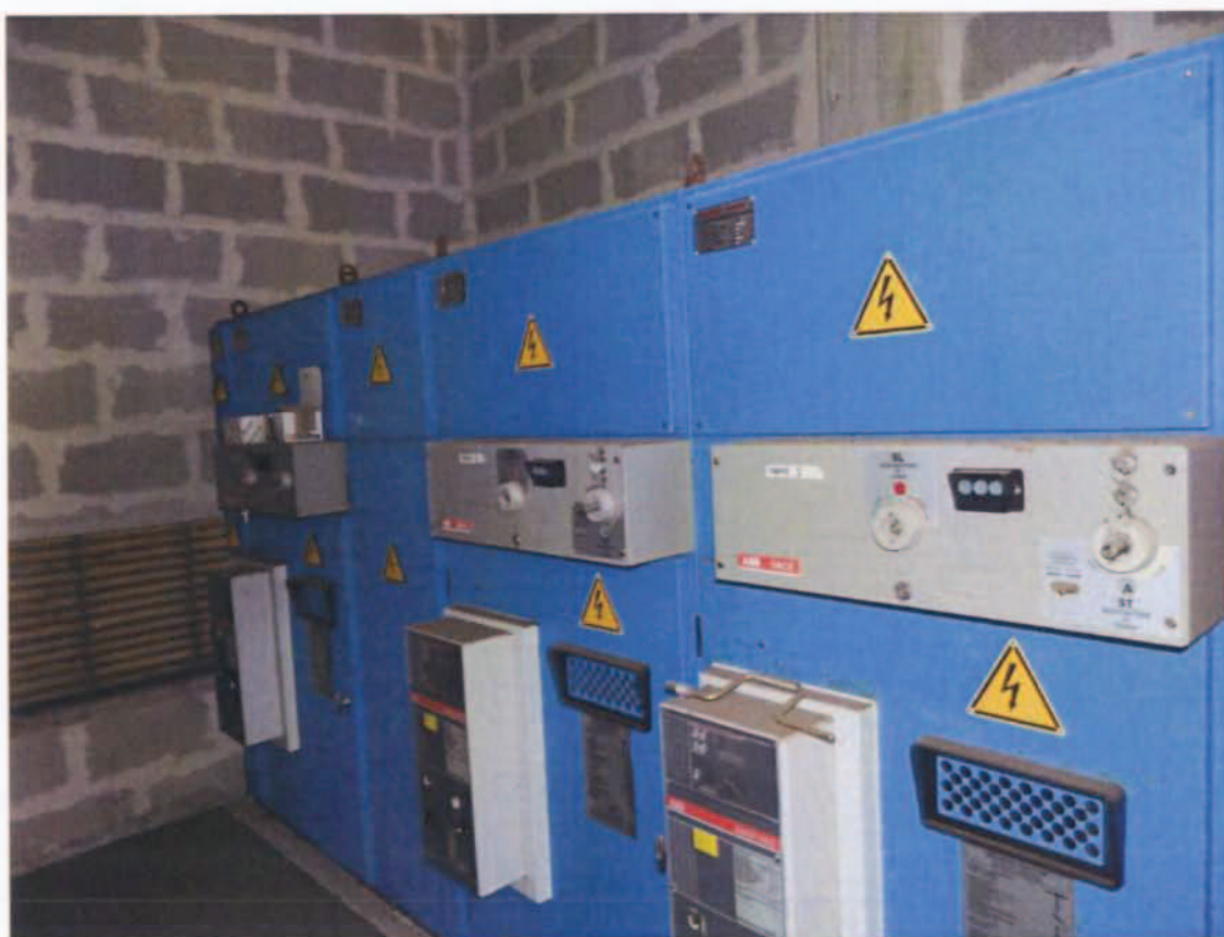
Centrale di trasformazione elettrica
