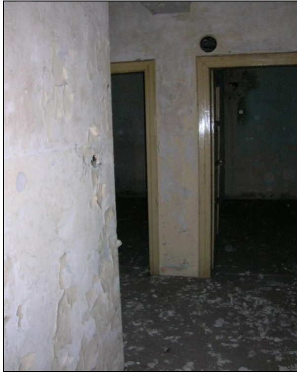
Foto 1 - stato manutentivo pavimentazione e tramezzi dell'ingresso/corridoio.
