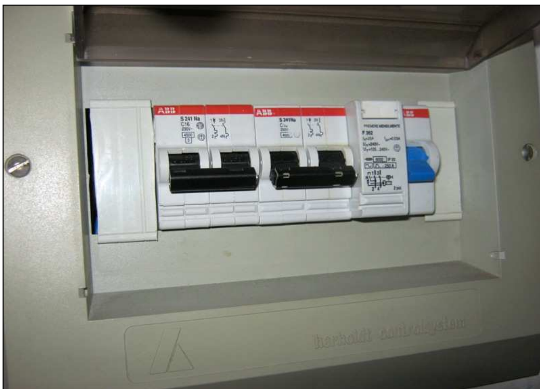
Foto 6 – quadro elettrico unità immobiliare.
