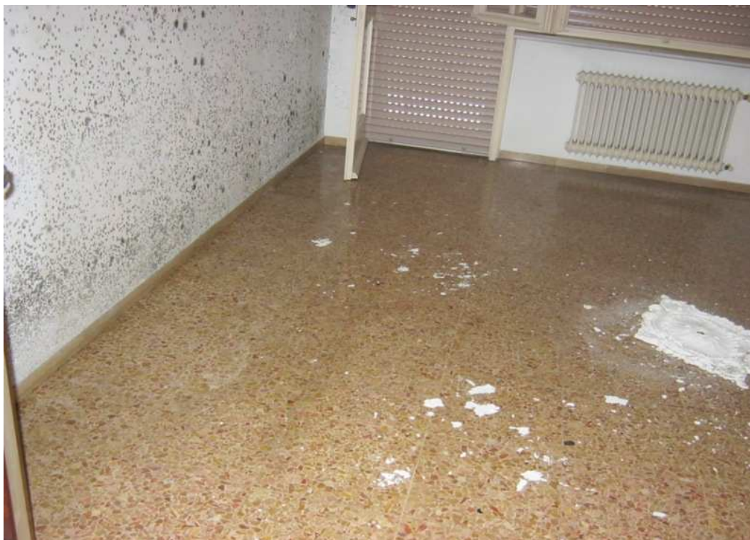
Foto 1 - stato manutentivo pavimentazione dell'ingresso / corridoio e soggiorno.
