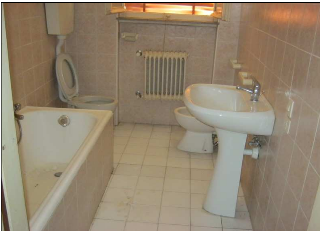
Foto 2 - stato manutentivo pavimentazione del bagno.
